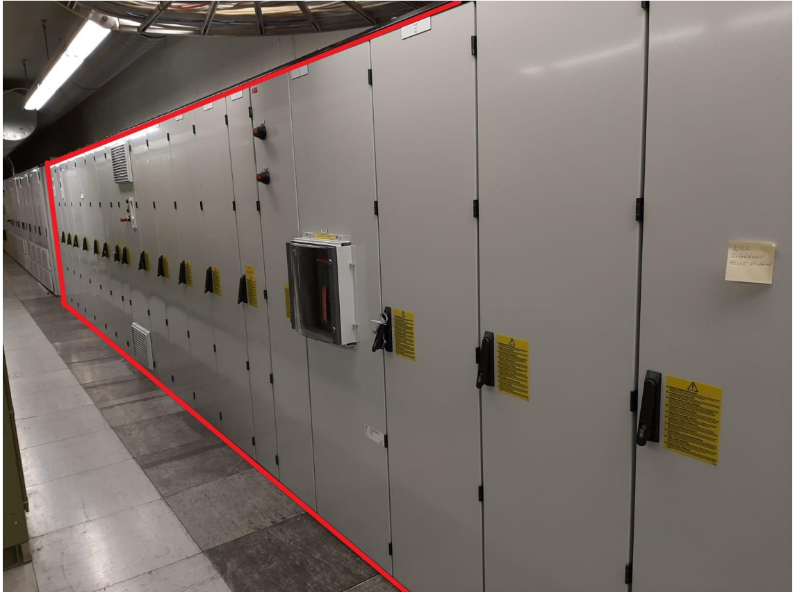
Kuva 18. Vetokonetta ohjaava ACS880 taajuusmuuttaja. Taajuusmuuttajaan kuuluvat modulit rajattu punaisella.
