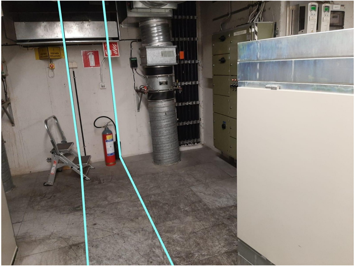
Kuva 8. Kaapeleiden tulo kellariin ja reitin jatkaminen kellarissa.
