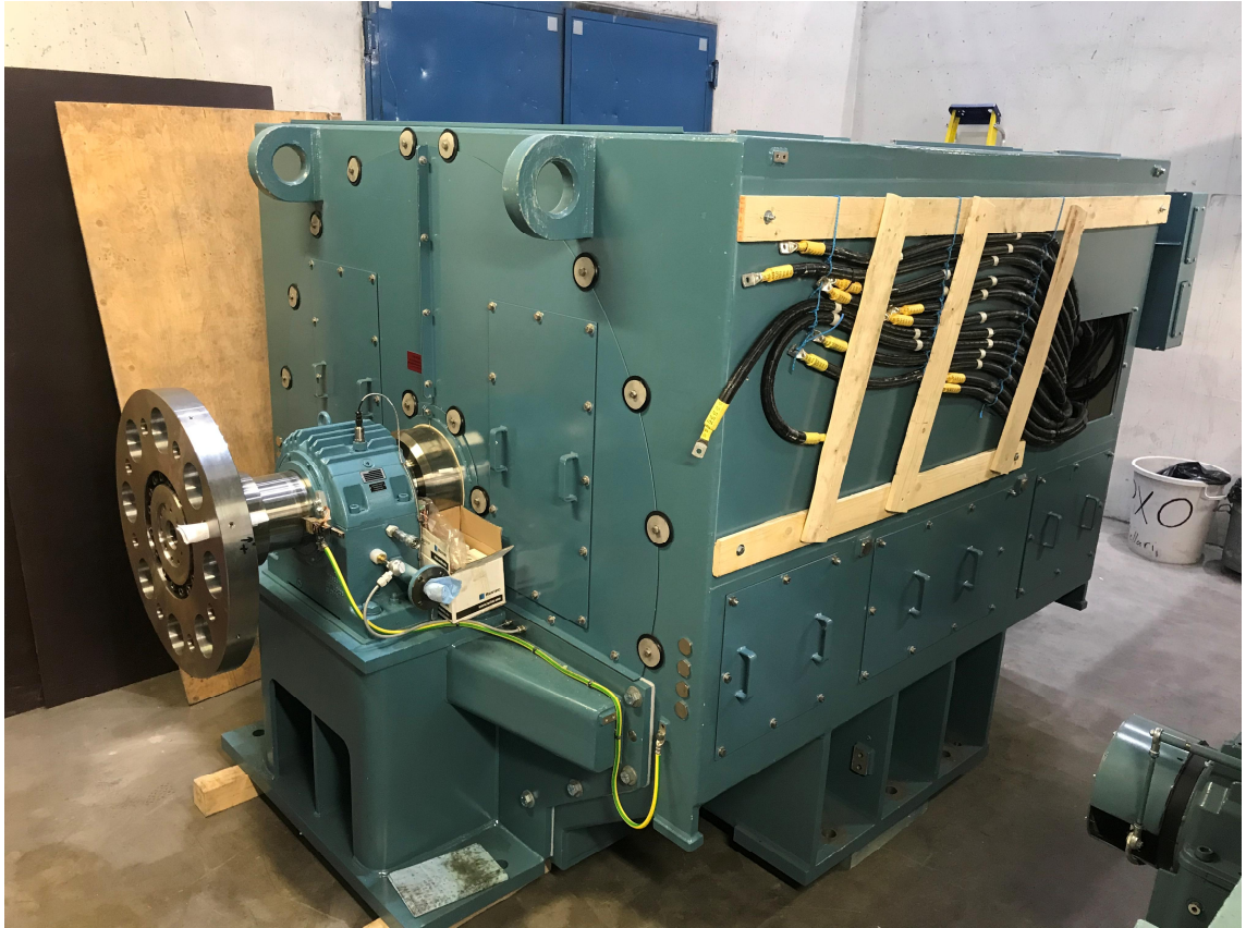
Kuva 39. Koestusgeneraattorina toimiva tahtigeneraattori.
