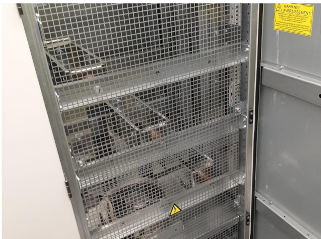
Kuva 27. Taajuusmuuttajan lähtöyksikön toinen moduuli.
