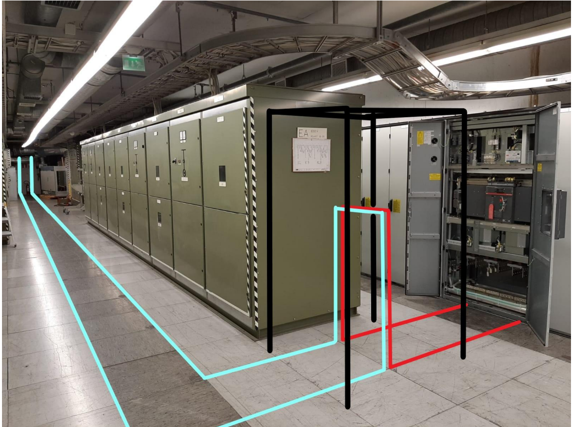
Kuva 9. Kaapelireitti tulo jakokaapille.
