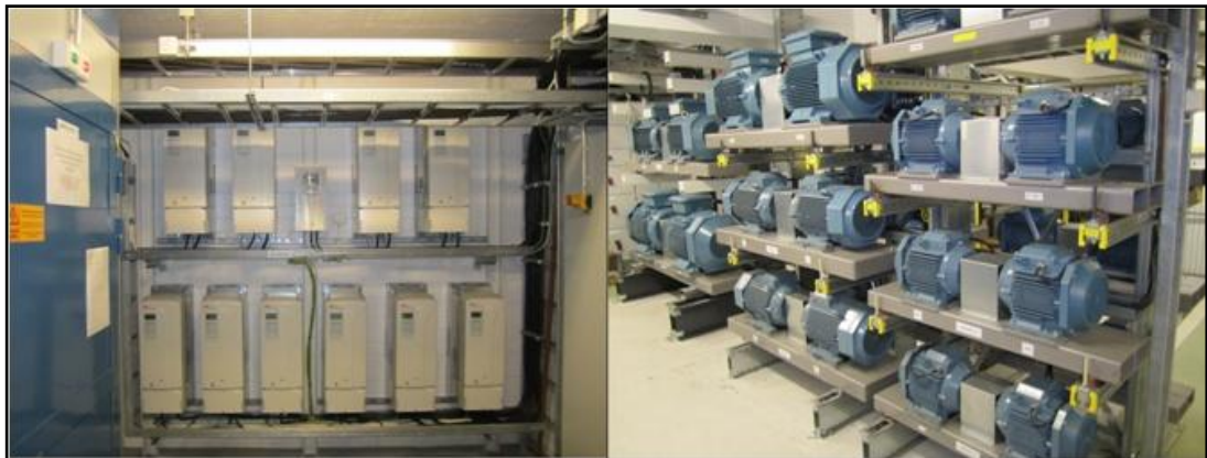
Kuva 20. Verkkoonjarruttavat taajuusmuuttajat sekä moottorikuormat
