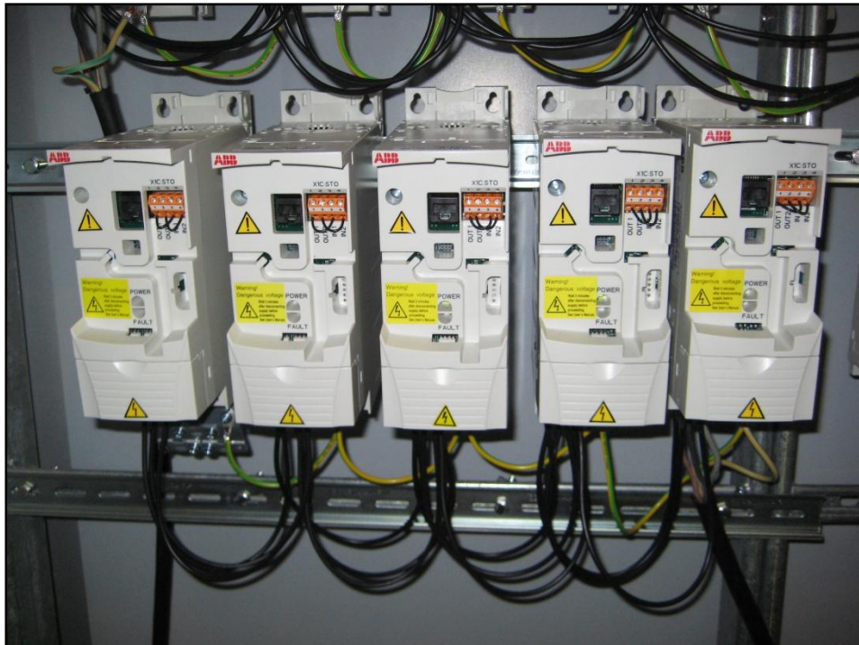
Kuva 29. Tyhjäkäynnissä olevien laitteiden virransyötön ketjutus
