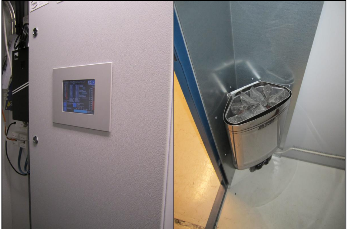
Kuva 24. Lämpötilan ohjausyksikkö ja 2,3 kW:n kiuas
