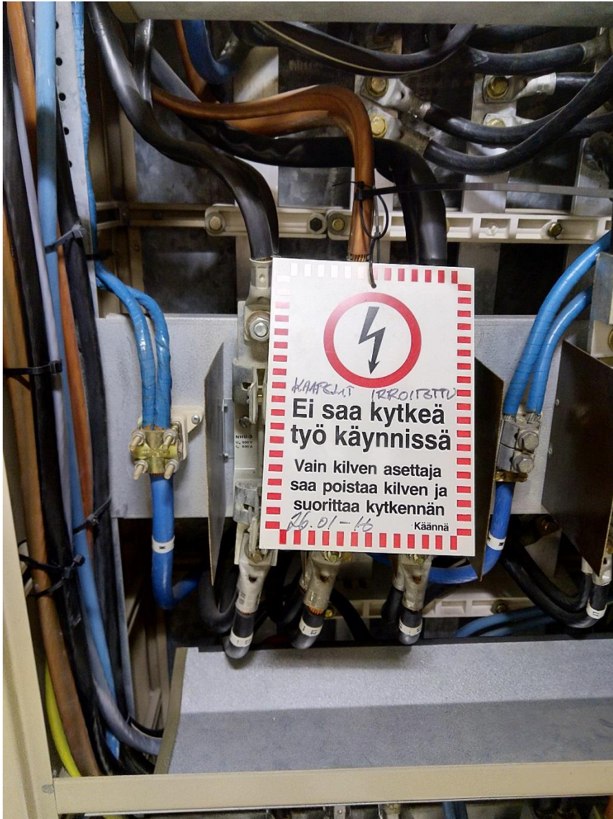
Kuva 13. NK2:ssa poistettu toinen loisivirran kompensointi laitteisto, kaapelit yhä asennettuna laitteistoon, mutta irti kytketty kojeistosta.
