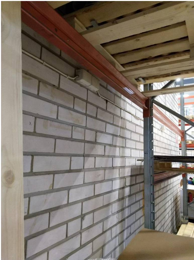
Kuva 3. Verstaan ulkoseinässä turha pistorasiaryhmä, jota ei voi käyttää hyllyjen takia. KORJATTU 5.10.2018
