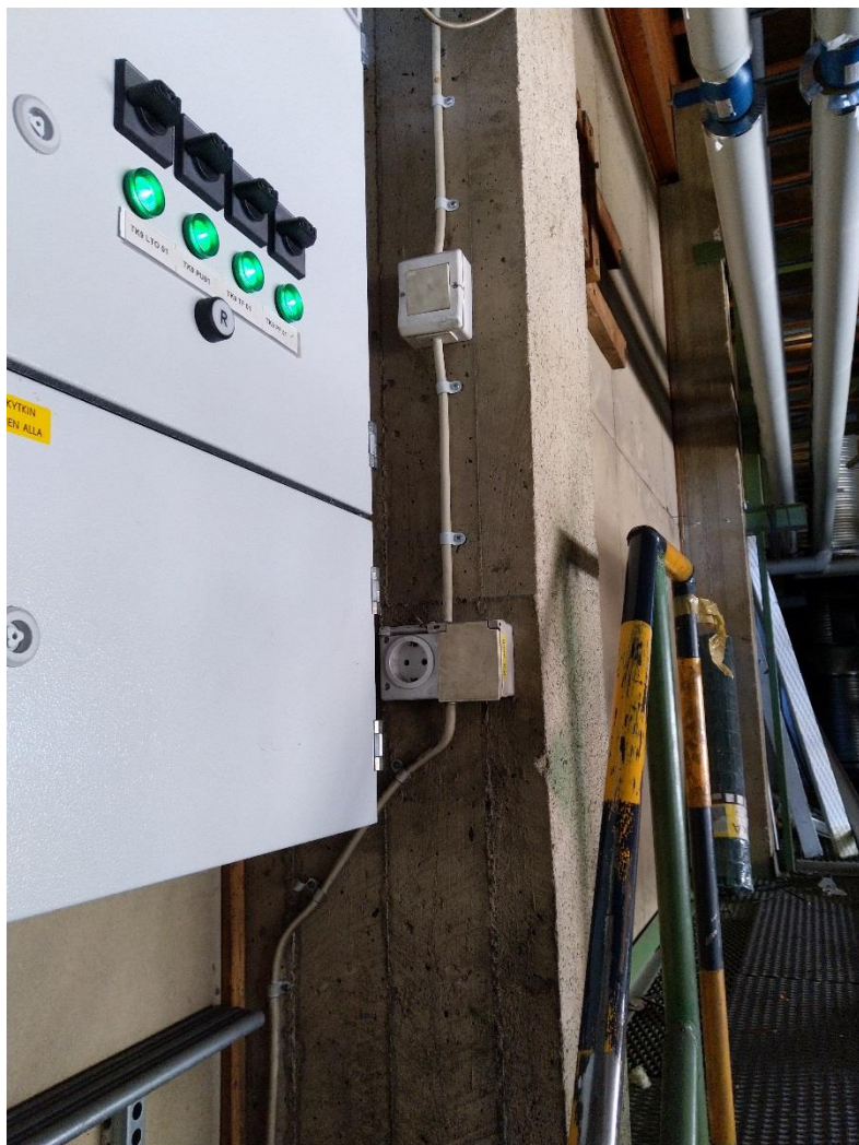
Kuva 4. Korkeassa osassa rikkoutunut pistorasia. KORJATTU 4.10.2018
