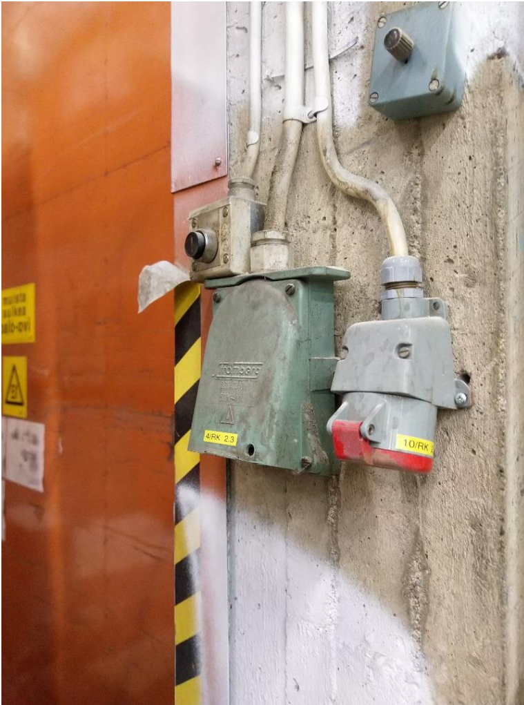
Kuva 2. Valaisinkeskuksen vieressä turha hitsauspistorasia, joka poistettava
