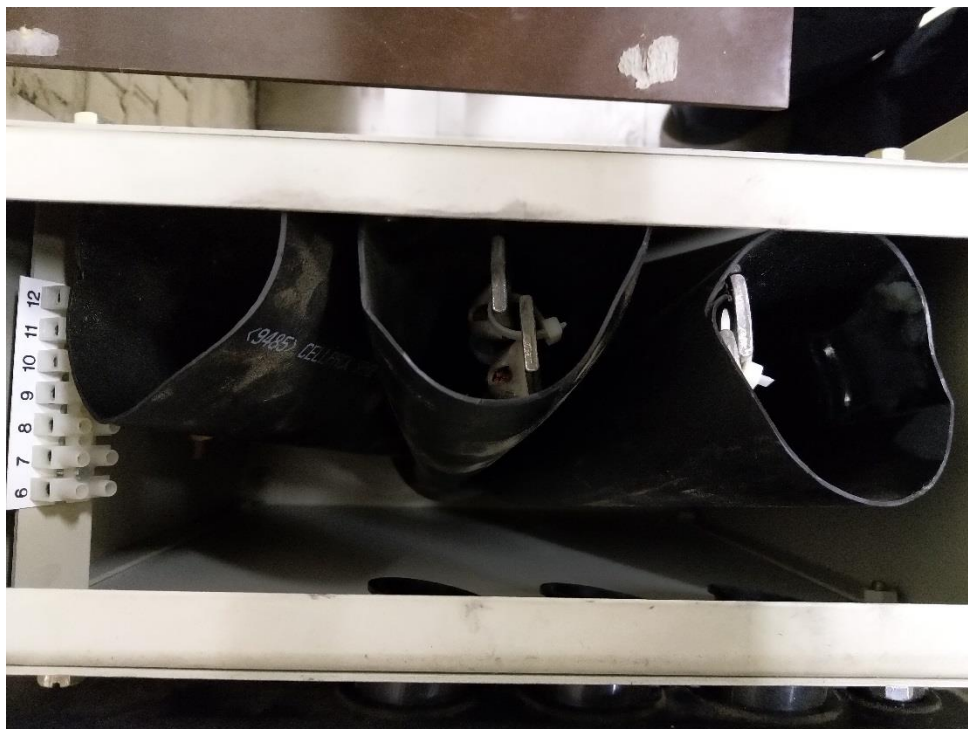
Kuva 14. Syöttäkaapeleiden päät käytöstä poistetussa kompensointilaitteistossa. Kutistesukat täytyy kutistaa kaapelikenkien päälle.
