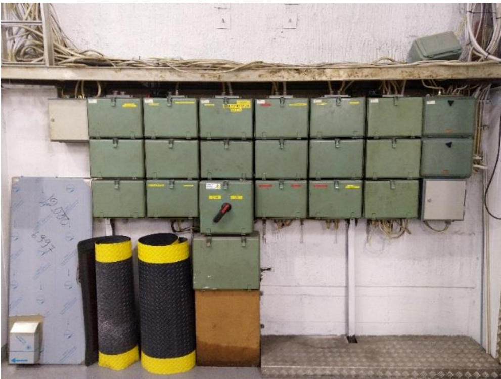
KUVA 9. Rakenteeltaan vanhanaikainen kotelokeskus, joka on valmistettu metallista.
