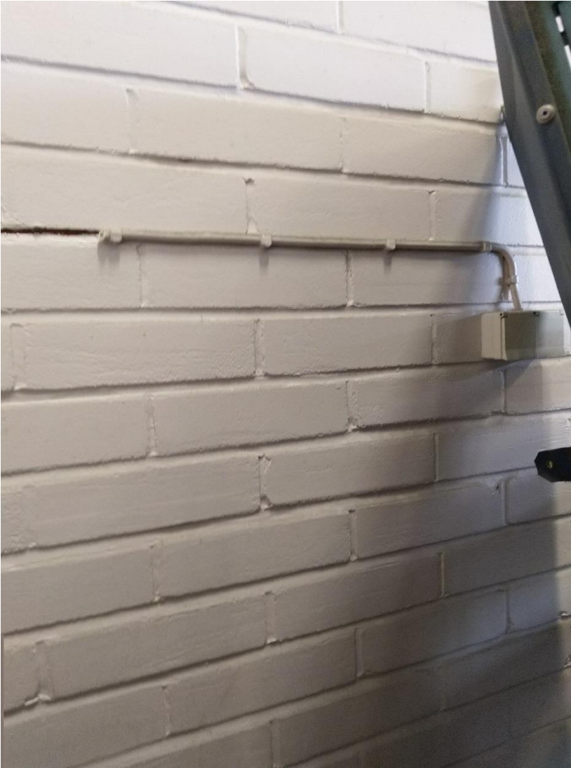
Kuva 7. Pääoven portaikon alla turha pistorasia
