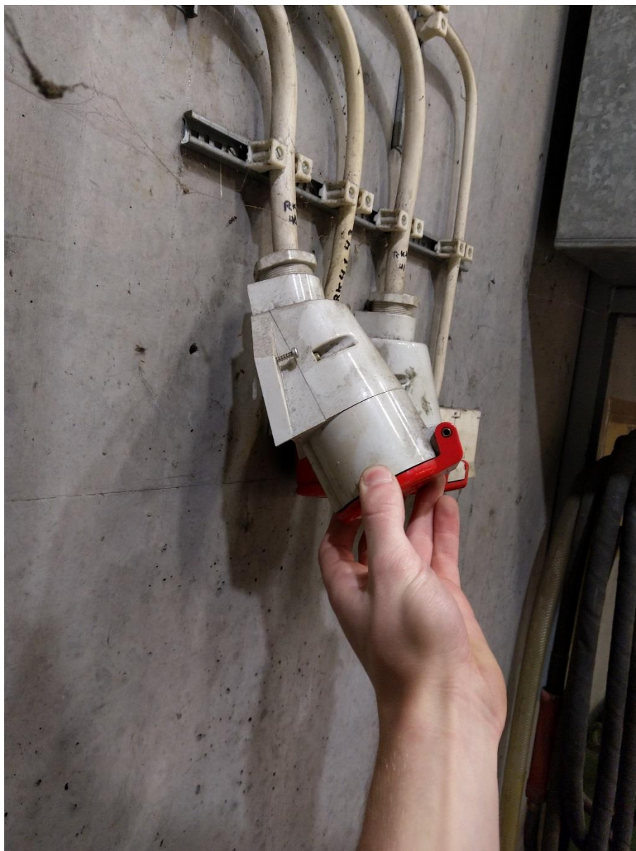
Kuva 12. 4 hallissa seinästä irronneita pistorasioita. KORJATTU 11.10.2018
