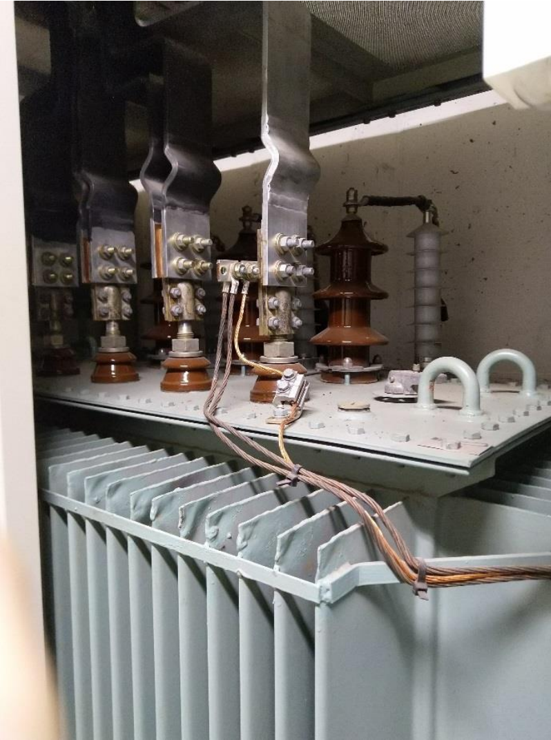
KUVA 6. Tehtaan 20 kV/400 V muuntaja
