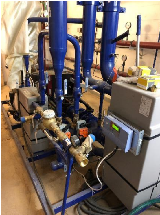
Kuva 5. Kaukolämmön lämmönvaihdin lämmönjakohuoneessa, joka on ensimmäisiä valmiita tiloja rakennuksessa.
