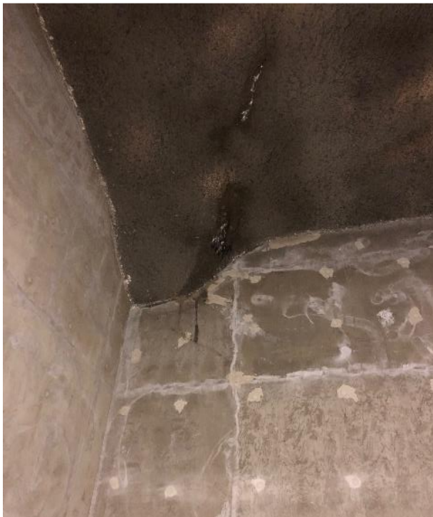
Kuva 11. Halkeama ruiskubetonikatossa, josta pääsee tippumaan vettä.
