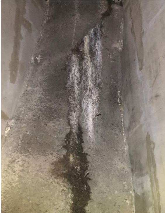
Kuva 3. Vesivuotojen aiheuttamaa kalkkisaostumaa sekä valuvaa vettä ruiskubetonipinnassa.
