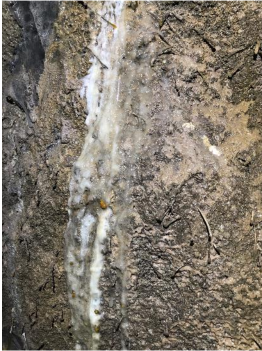
Kuva 2. Ruiskubetonipinnassa olevia valumia kemiallisen jälki-injektionin jäljiltä.
