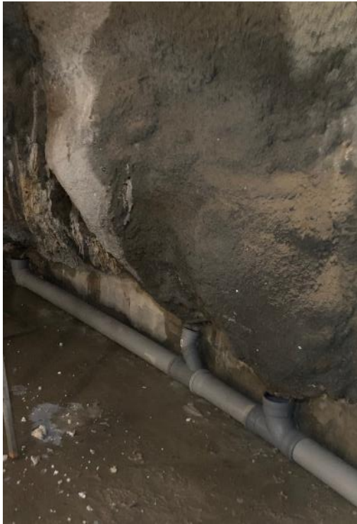
Kuva 13. Kalliosta valuva vesi ohjataan putkien avulla suoraan pumppaamoon.
