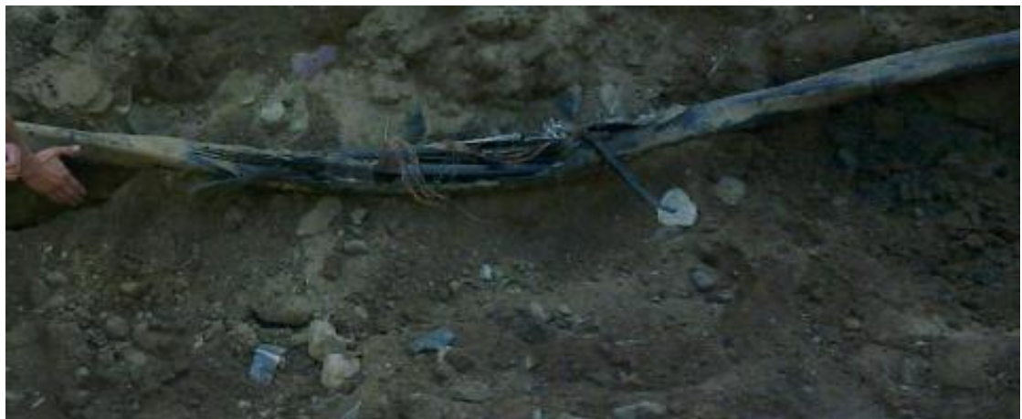
Kuva 5. Vahingoitettu 20MV kaapeli (Kuva: Henri Annala).
