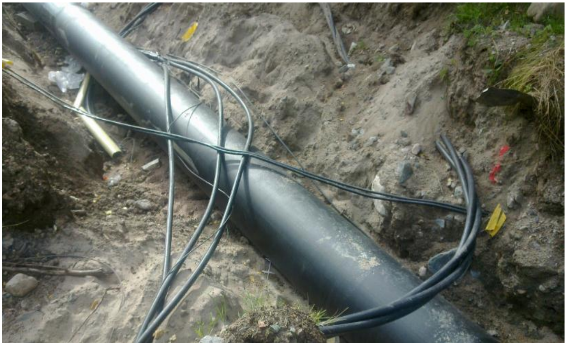
Kuva 6. Useita kaapeleita pienellä alueella (Kuva: Henri Annala).
