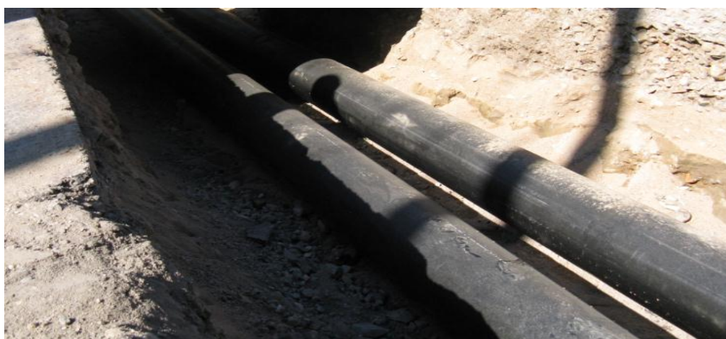
Kuva 3. Kaivannon seinämiltä pudonneita kiviä, jotka tulee poistaa ennen täyttöä (Kuva: Henri Annala).
