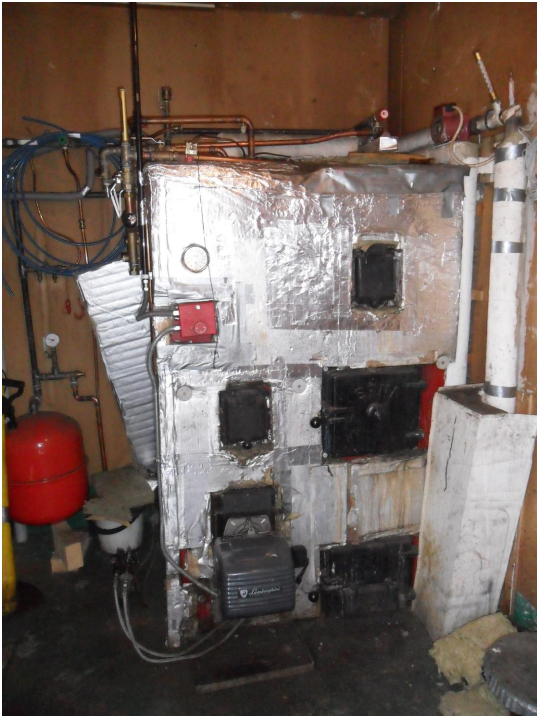
Kuva2. Taloyhtiön omatoimisesti eristetty öljykattila
