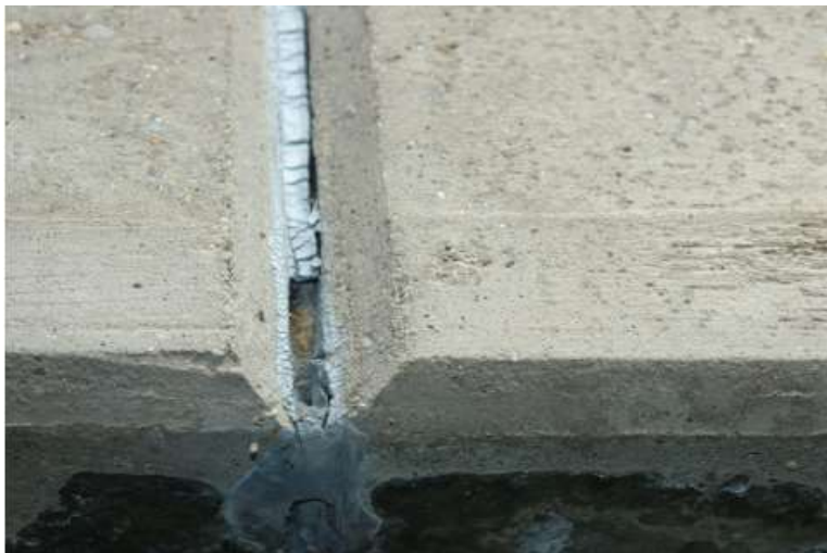
Kuva 5. PCB-yhdisteitä sisältävää elementtien saumausmassaa [25, s. 2].
