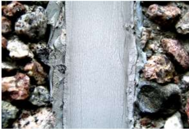
Kuva 8. Vanhaa PCB-pitoista saumausmassaa ei ole poistettu huolellisesti saumauksen uusi- misen yhteydessä, joka näkyy erillisinä kerroksina uuden saumausaineen reunoilla [38, s. 12].
