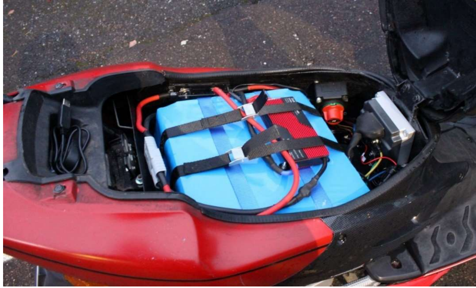
Kuva 15. Penkin alle asennettu tekniikka. Akun ohjainlaite ja päävirtakytkin.
