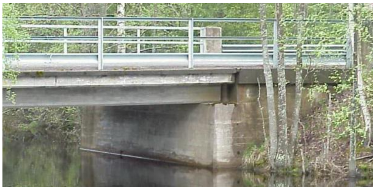
Bild 23. Sidoslänterna ser inte ut att behöva sljning, men träd har tillåtits växa. (D-anmärkning). (Tiehallinto 2009)
