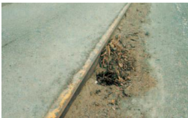
Bild 16. Ett stuprör som täppts till (B anmärkning). (Tiehallinto 2004)
