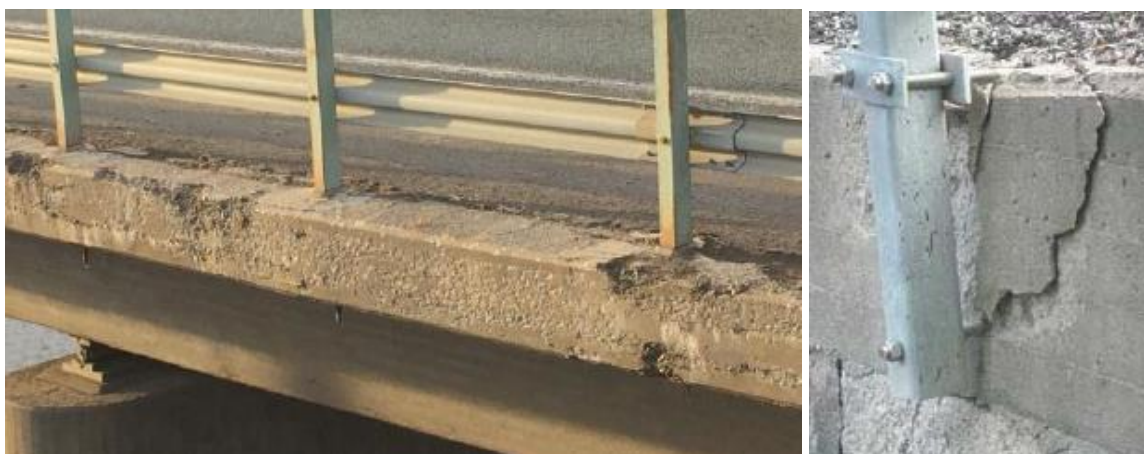
Bild 8. Till vänster, trots ren, en kraftigt korrosions skadad sidobalk. Till höger en korrosionsskada som försvagat staketets fastsättning. (Bägge D-anmärkning) (Leinonen 2018. Tiehallinto 2009)
