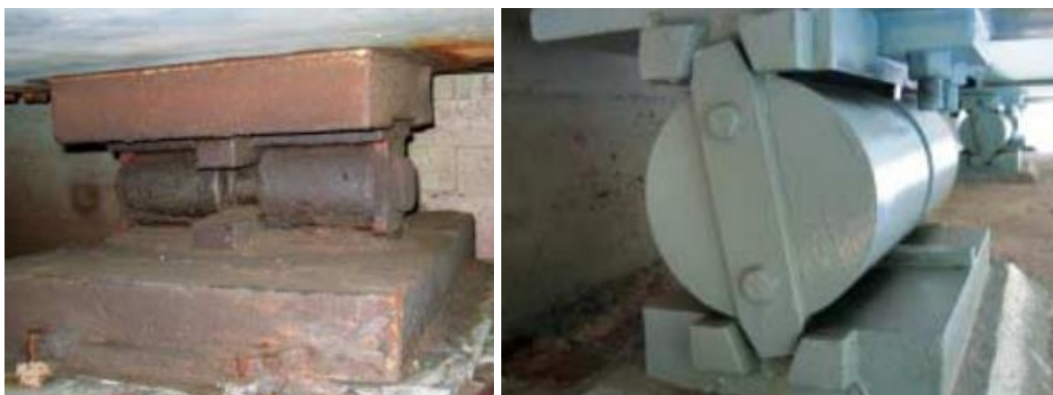
Bild 15. Till vänster ett lager som rostade avsevärt (D-anmärkning). Till höger ett s.k. rull-lager i ytterst bra skick (A-anmärkning).
