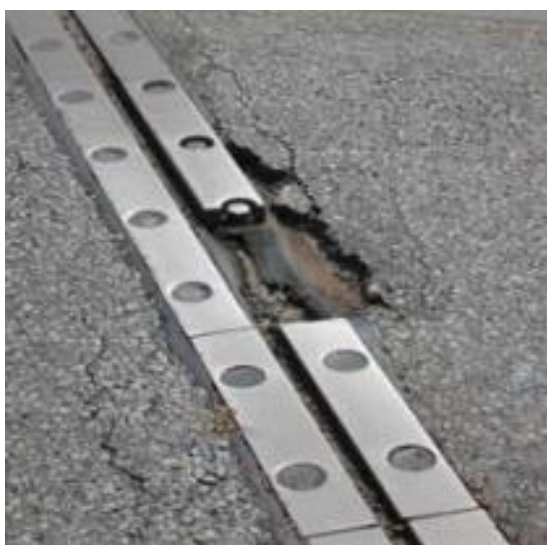
Bild 14. En tydlig spricka har uppstått vid anordningens sidostöd och en del har lossnat. (C-anmärkning) (Liikennevirasto 2014)
