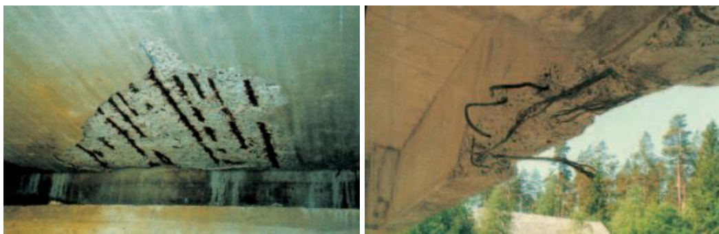
Bild 7. Till vänster en ytterst grov korrosionsskada i däckplattans undersida, till höger en grov krockskada i däckplattans sidoelement. (Bägge D-anmärkningar) (Tiehallinto 2004)
