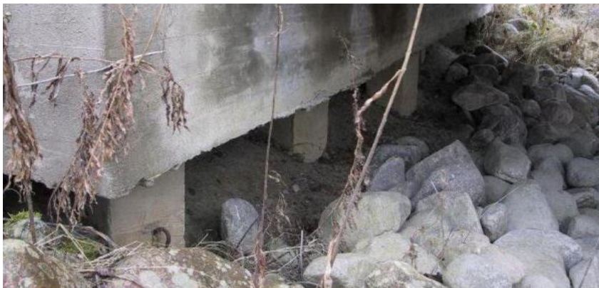
Bild 22. Grova erosioner i rampens underliggande jordmassa (D-anmärkning). (Tiehallinto 2009)
