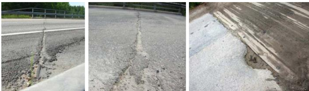
Bild 11. Den vänstra och mittersta slutfogen kräver rengöring (B-anmärkning).
