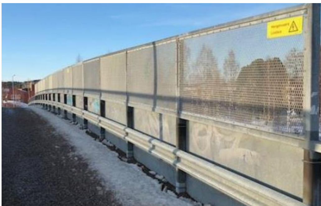
Bild 18. Staketet är till synes i gott skick (A-anmärkning). (Leinonen 2018)
