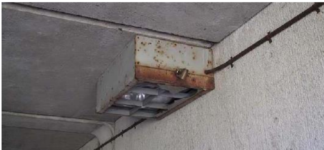
Bild 19. Belysningsanordningen är i behov av reparationer (D-anmärkning). (Tiehallinto 2009)
