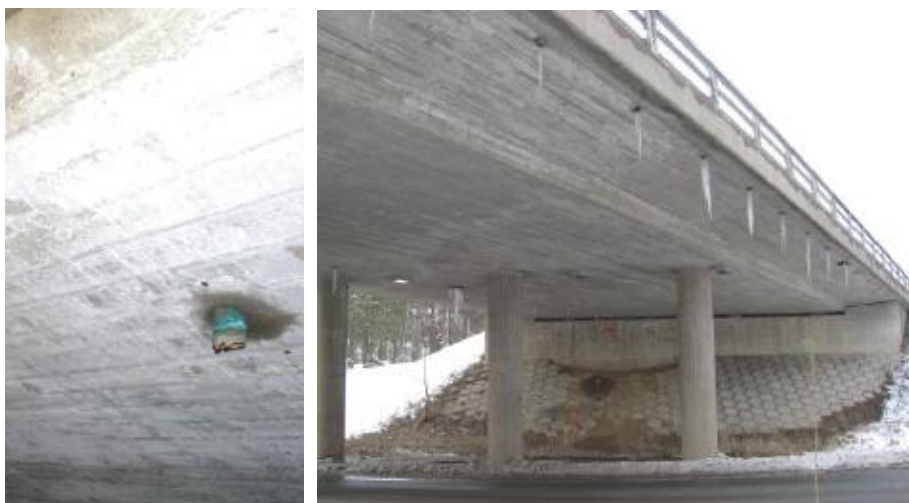
Bild 17. Till vänster ett fallrör som uppvisar både inre läckage och början av kalkbildning. Till höger en bro med felkonstruerade fallrör som ligger ovanför trafikleden. (Bägge D-anmärkningar). (Tiehallinto 2009)
