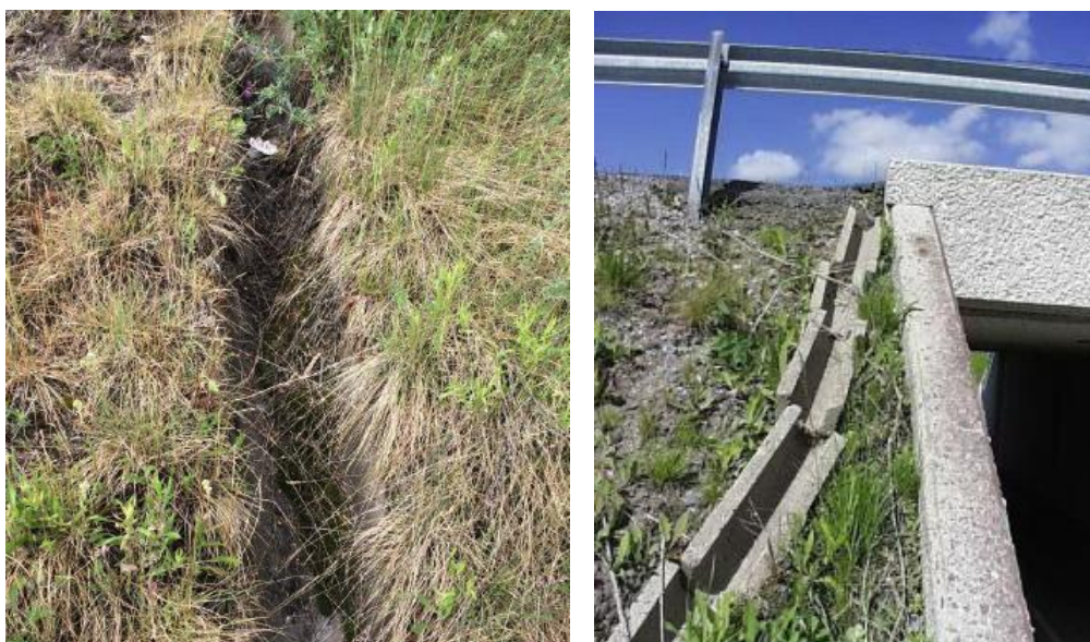
Bild 21. Till höger har betongelementen förskjutits och kräver underhåll (C-anmärkning) Till vänster kräver anordningen röjning från växtlighet (B-anmärkning) (Leinonen 2018. Tiehallinto 2009)
