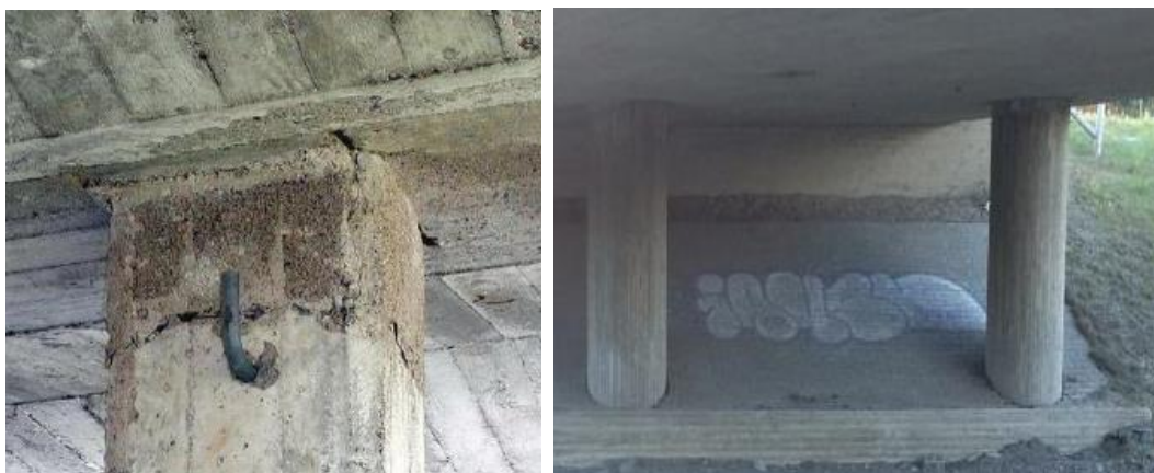
Bild 5. Den vänstra bildens mellanstöd har flagnat kraftigt på grund av korrosion (D-anmärkning). Den högra bildens mellanstöd är rena och i gott skick (A anmärkning). (Tiehallinto 2009. Leinonen 2018)
