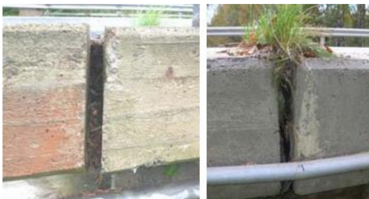
Bild 9. På bägge bilderna saknas rörelsefogarna helt. Den vänstra har fyllts med växtlighet, troligtvis till följd av dålig skötsel. (D-anmärkning) (Liikennevirasto 2014)
