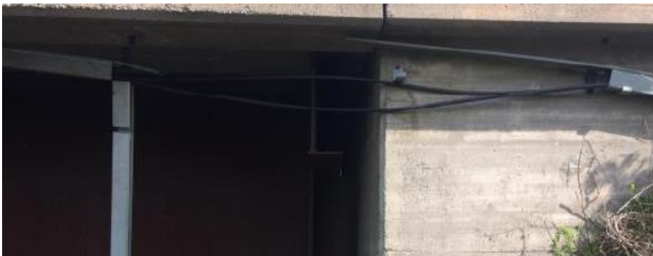
Bild 20. Kabelhylla som lossnat från sin fastsättning vid markstödet (D-anmärkning). (Leinonen 2018)
