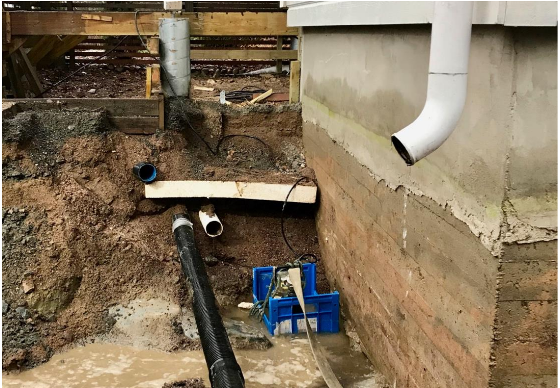
Kuva 6. Rakennuspohjalle soveltumaton salaojaputki sekä salaojitusmateriaali.
