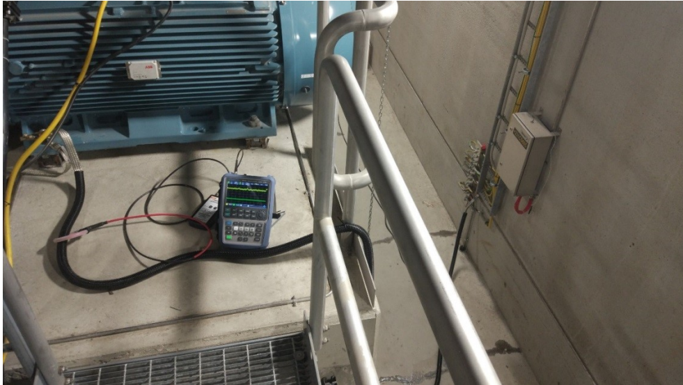
Kuvio 25. Runko maadoitettiin tilassa olevaan potentiaalintasauskiskoon ja mitattiin maadoituksen läpi kulkevaa virtaa
