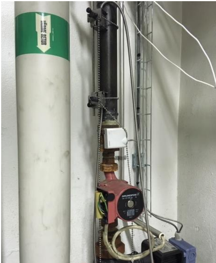
Figur 2. Givarna fastkedjade på stålröret efter pumpen.
