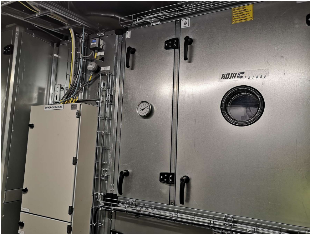
Kuva 4. Koja Future ilmanvaihtokone ja ala-asema.
