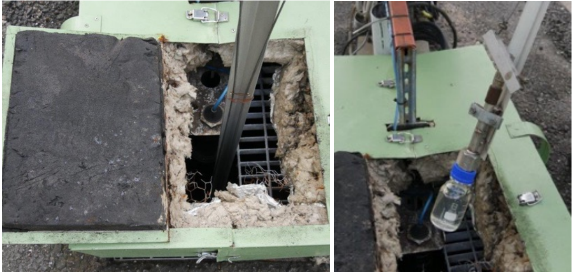
Kuva 3. Prosessivesinäyte öljyisen veden keräilykaivosta.
