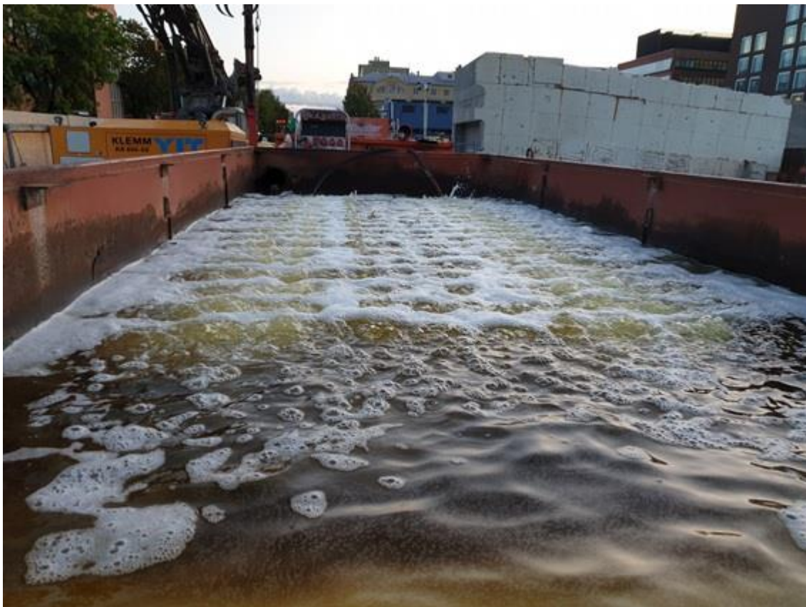
Kuva 16. Ilmastusallas, kun ilmastus on kytketty päälle
