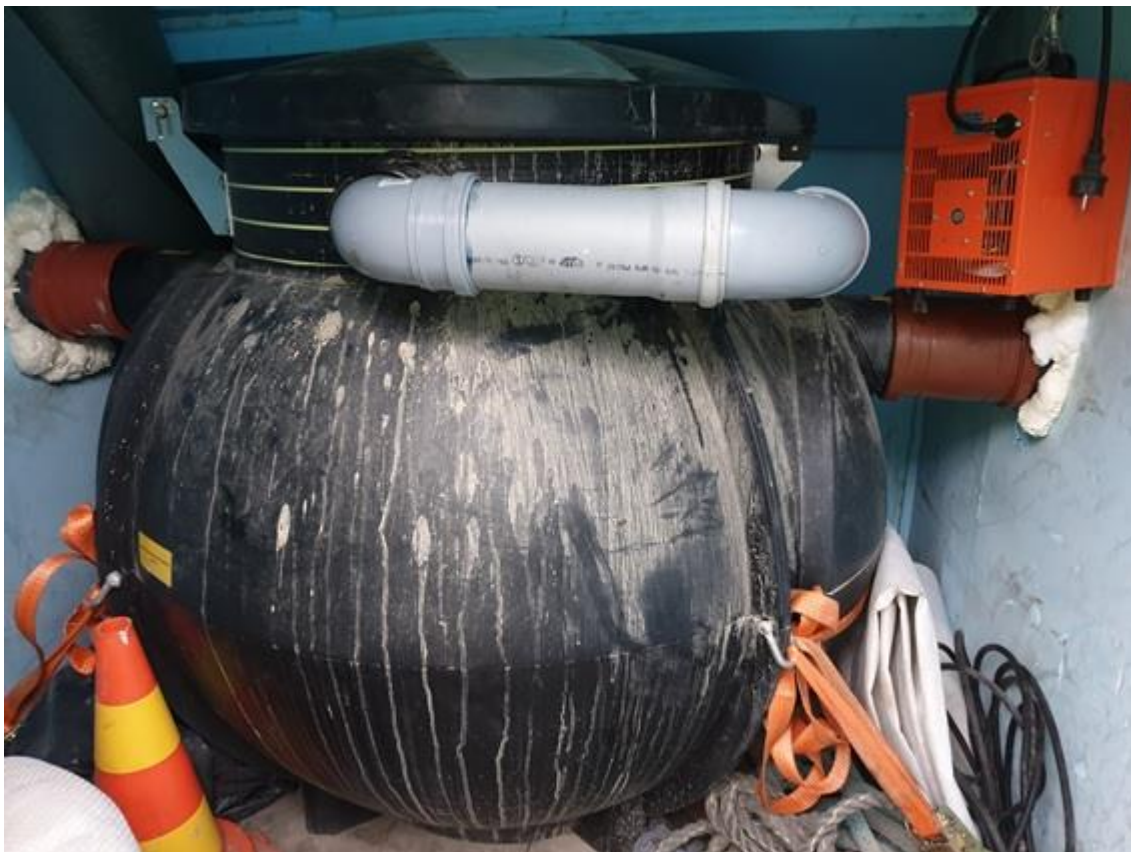
Kuva 14. Öljyerotin ja öljynkeräyssäiliö
