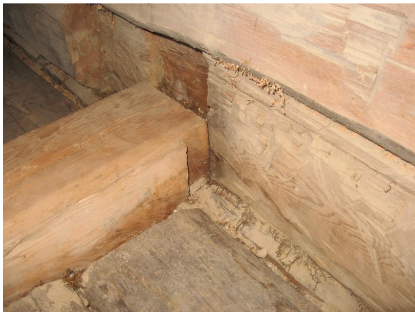
Kuva 21. Välipohjakannattajat irronneet sivuseiniltä.
