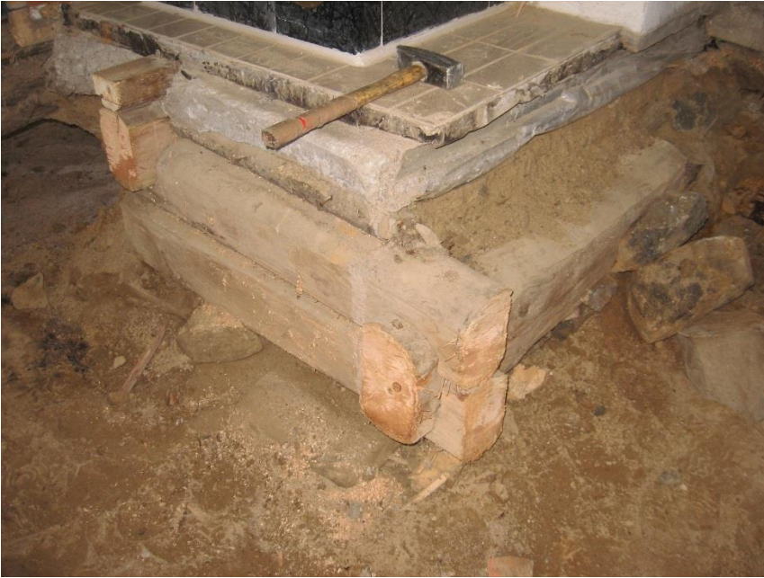
Kuva 11. Tulisijan perustukseen jätetyt puuosat.
