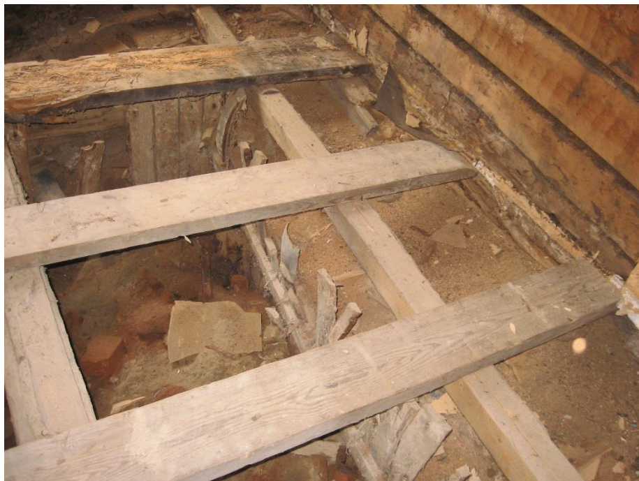
Kuva 17. Lahovaurioisia seinähirsiä ja lattiarakenteita.
