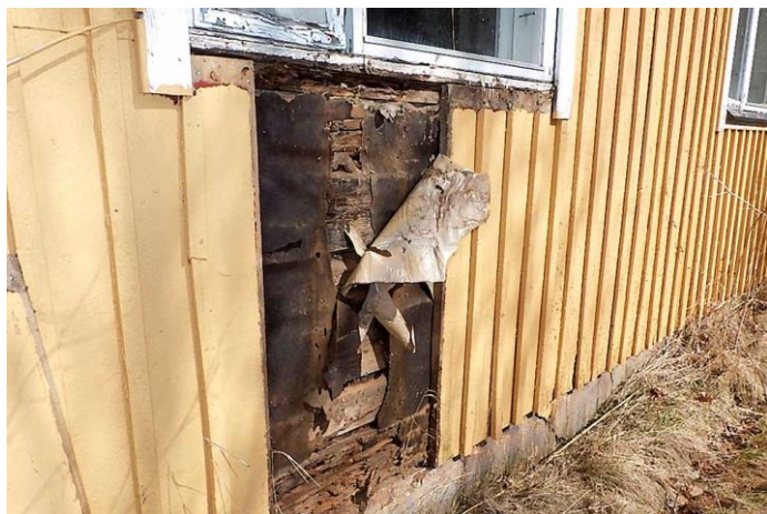
Kuva 8. Huonosti tuulettuva seinärakenne. (Suomela 2019.)
