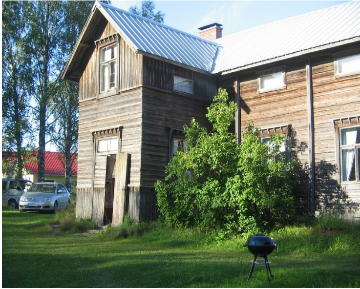
Kuva 9. Maan nousua ja kasvillisuutta perustuksen vieressä.
