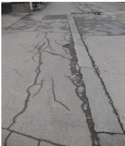
KUVIO 3 Pinta vaurioitunut
