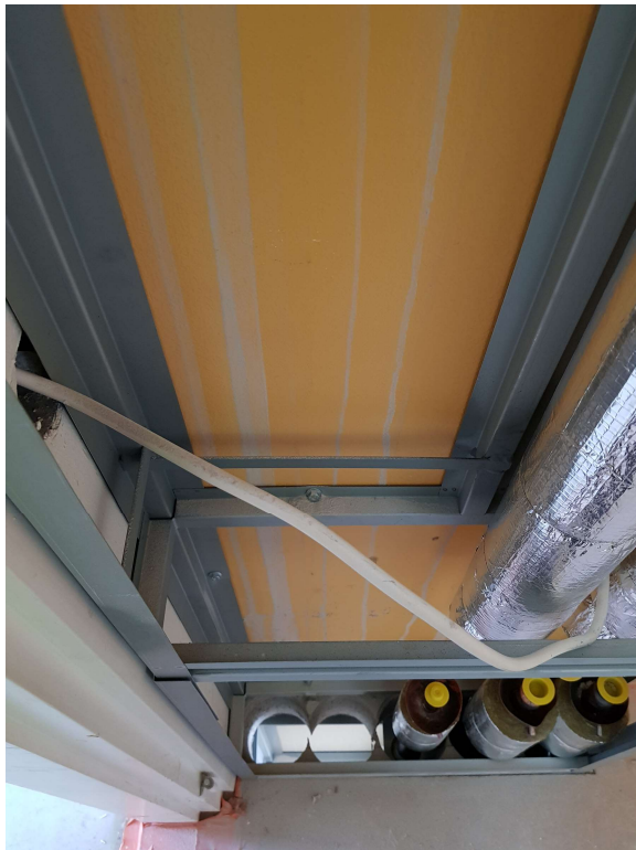
Kuva 6 Nousujohtokotelo asunnon eteisessä [4]
