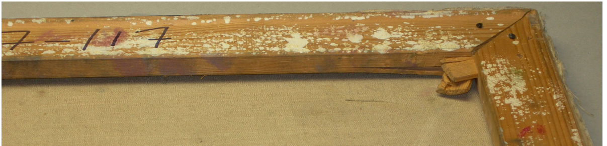
KUVA 10: Yläkiilapuun oikea kulma on haljennut ja kiilat ovat huonokuntoiset ja halkeilleet.
