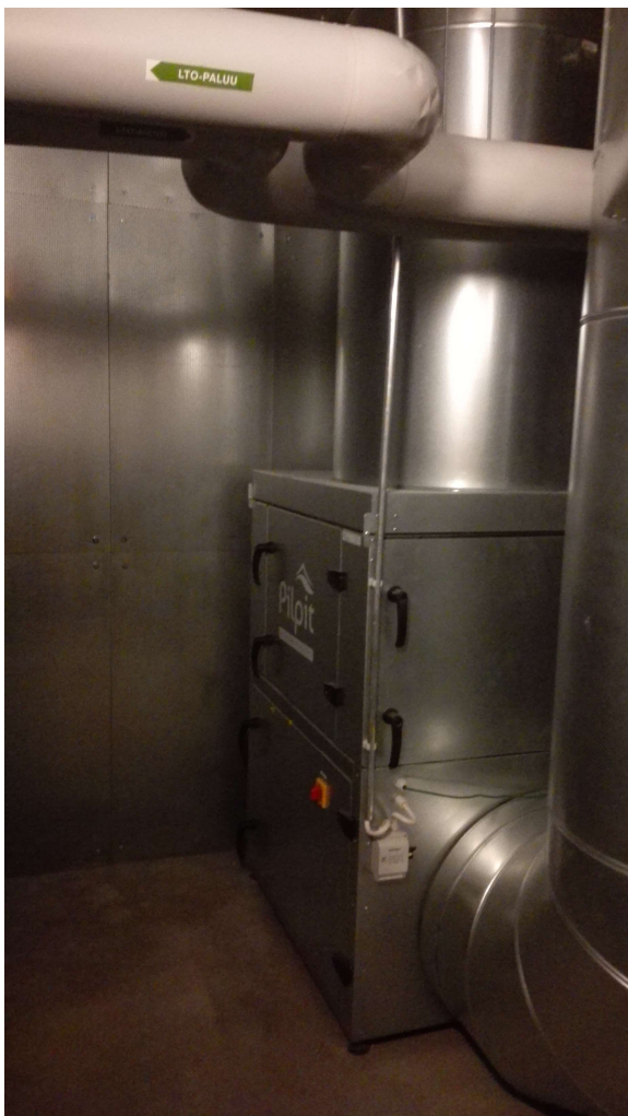
Kuva 17. PILP-järjestelmä sille rakennetussa kammiossa ullakolla.
