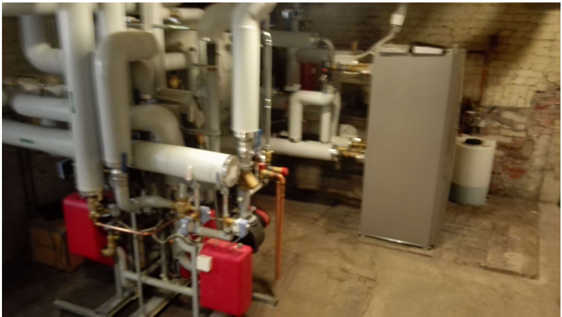
Kuva 11. Asunto Oy Töölö-Hesperia, kaukolämpökeskus
