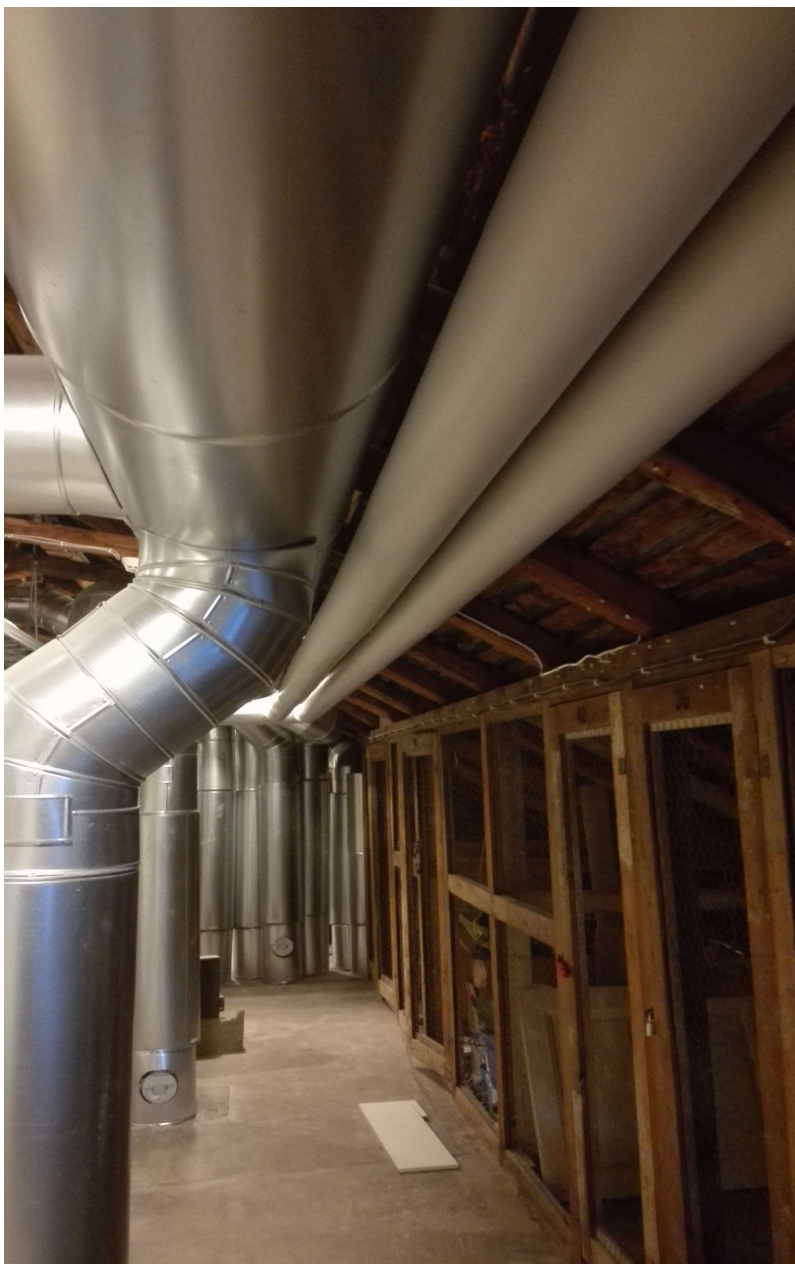
Kuva 16. Ullakkokerroksen lämmöntalteenoton keruuputkistot eristettynä.
