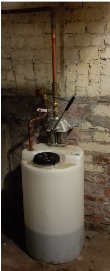
Kuva 13. LTO:n keruuputkiston glykolitäyttöastia käsipumpulla.
