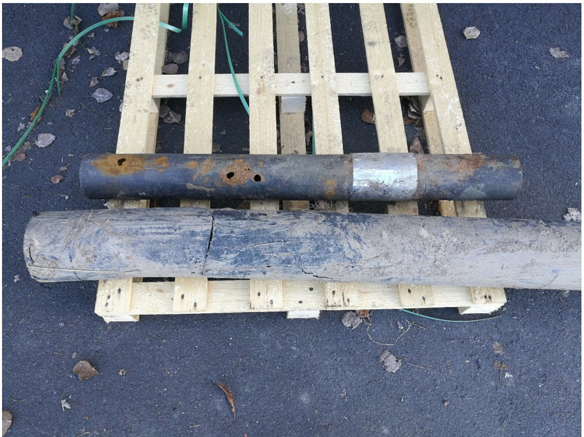
Kuva 1. Käytössä 22.4.2018 rikkoutuneita vesijohtoja (Forssan vesihuoltoliikelaitos).
