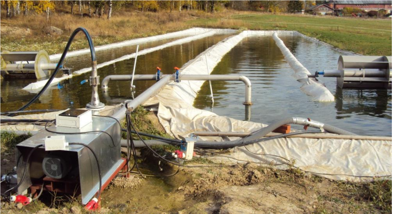
Kuva 14. Pumppu, jolla pumpataan levät erotukseen ja ruokailuun. Hiilidioksidia syötetään harmaata putkea pitkin siipirattaan etupuolelle.
