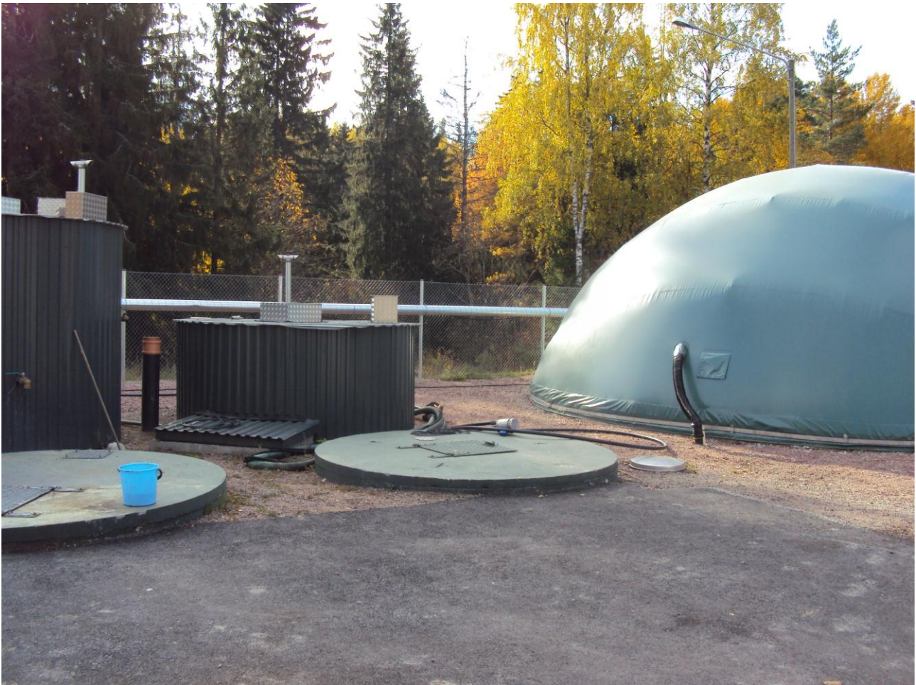
Kuva 18. Vasemmalla mädätyskaivot, oikealla biokaasusäiliö, johon valmis biokaasu johdetaan.
