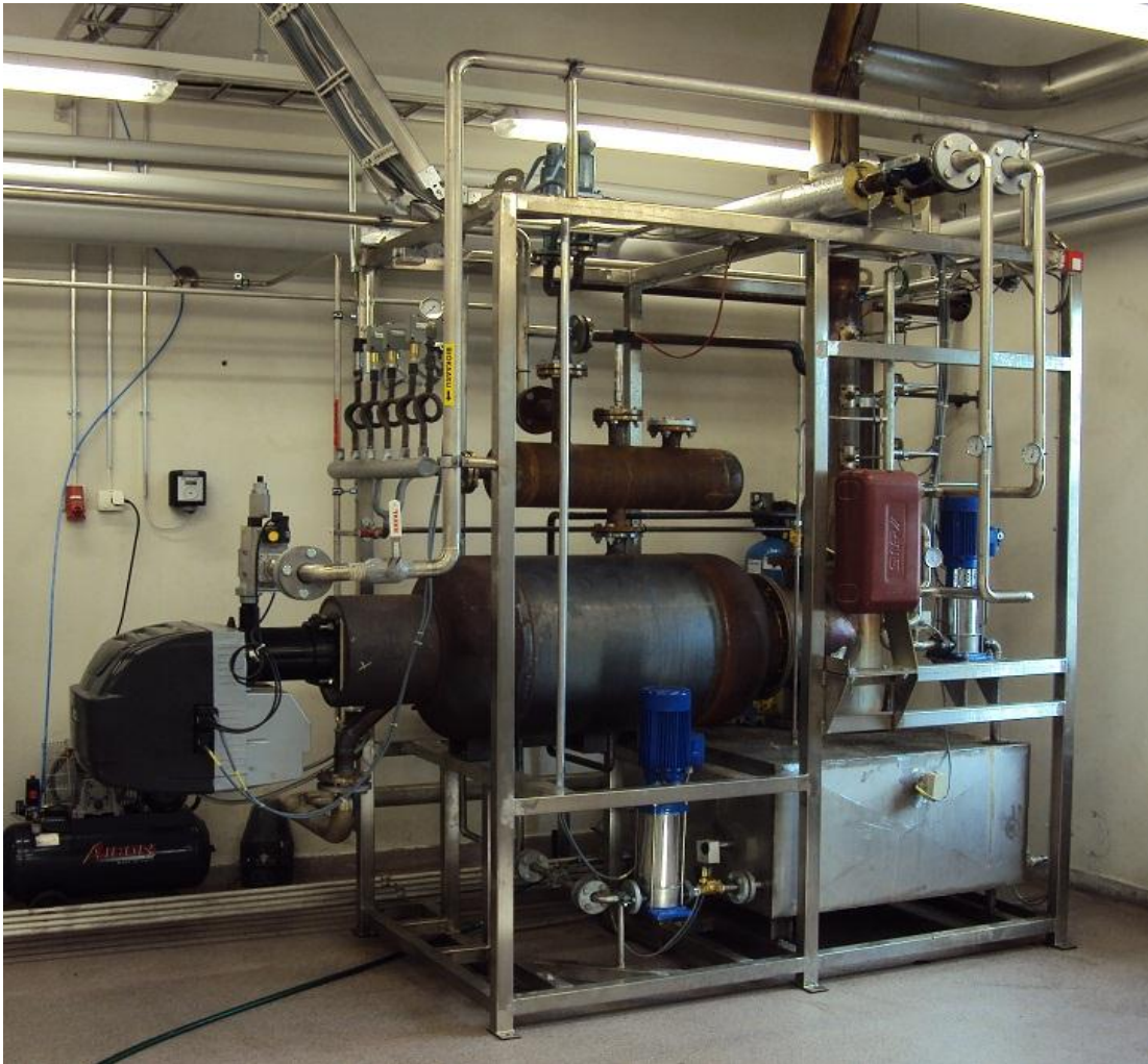
Kuva 9. Monipolttoainehöyrykattila, johon johdetaan joko biodieseliä tai biokaasua ja häkäkaasua (keskellä kattila ja poltin vasemmalla).
