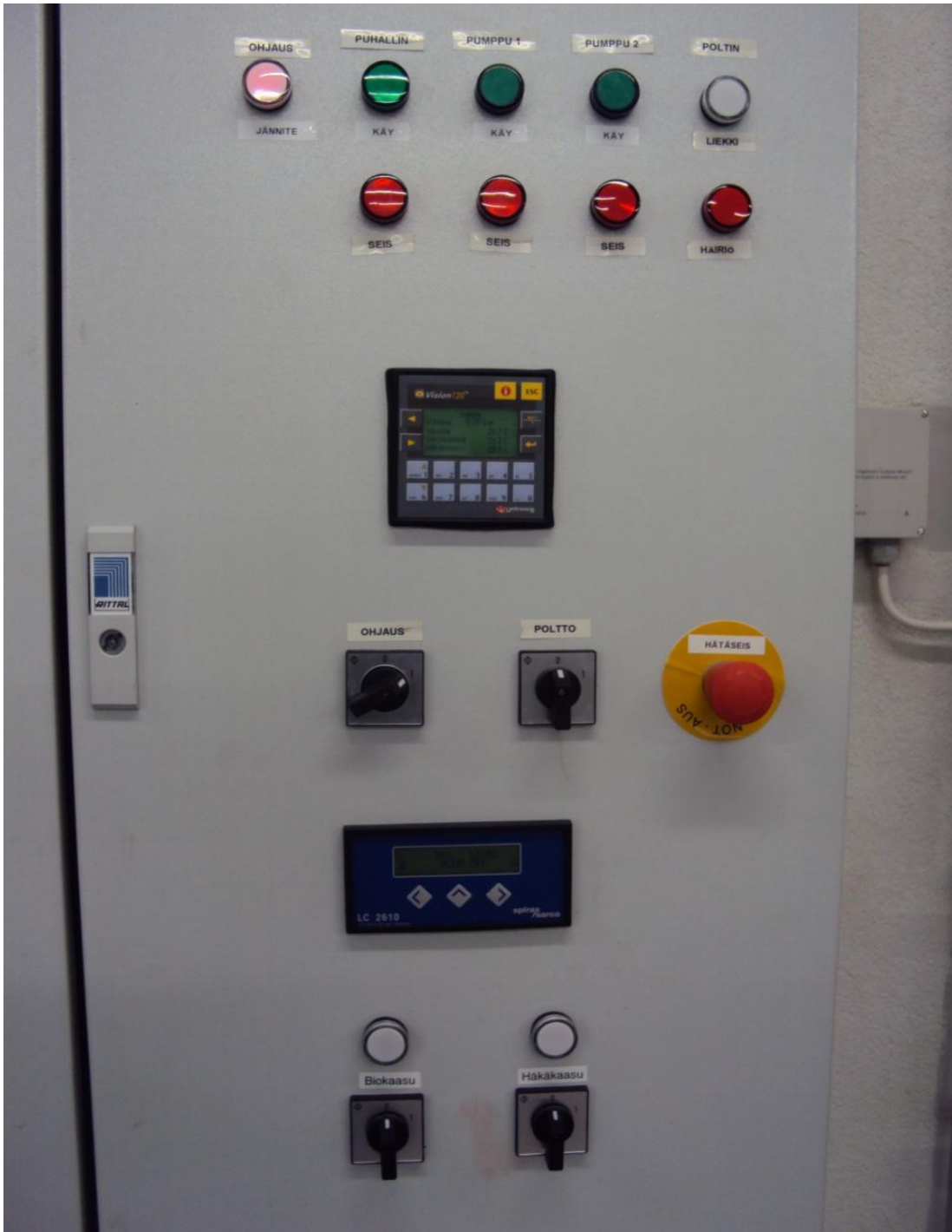
Kuva 11. Laitoksen ohjauspaneeli. Häkäkaasua voidaan tuottaa ulkona ja ohjata se kattilaan poltettavaksi.
