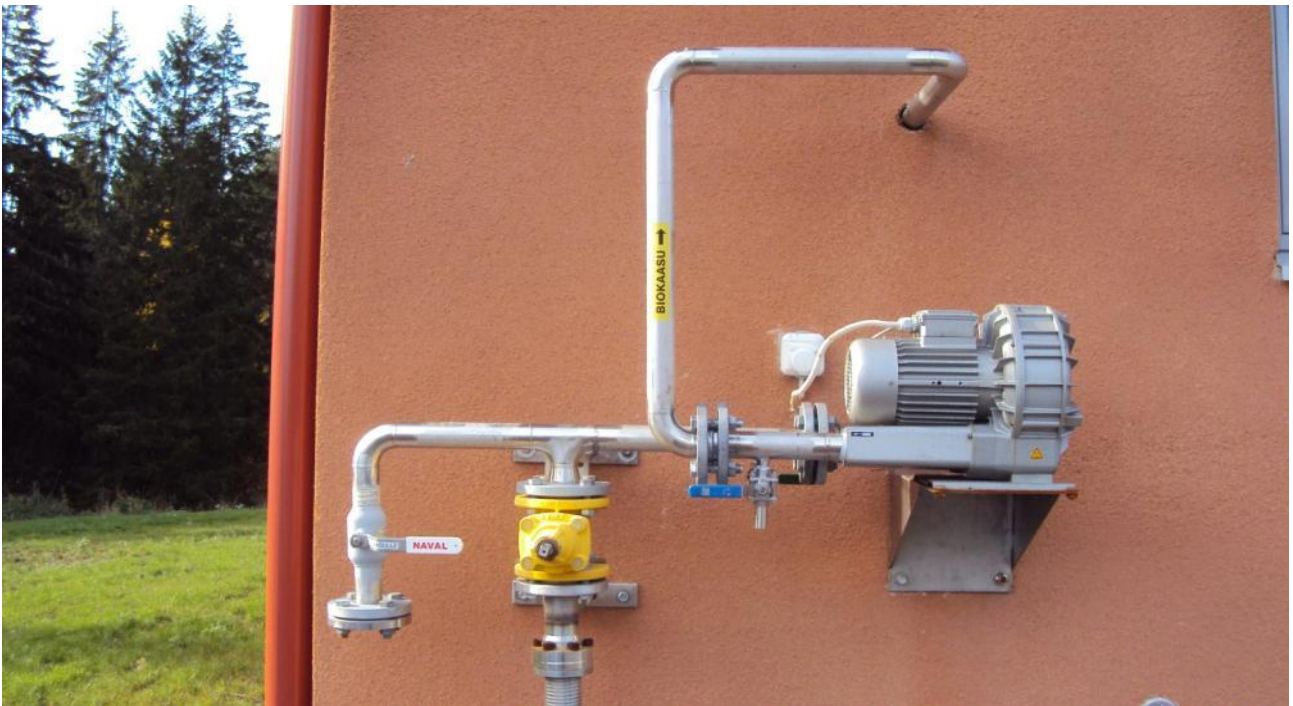
Kuva 19. Syöttöpumppu, jolla syötetään bioreaktorista saatavaa biokaasua monipolttoainekattilaan. paineenkorotus-lietso
