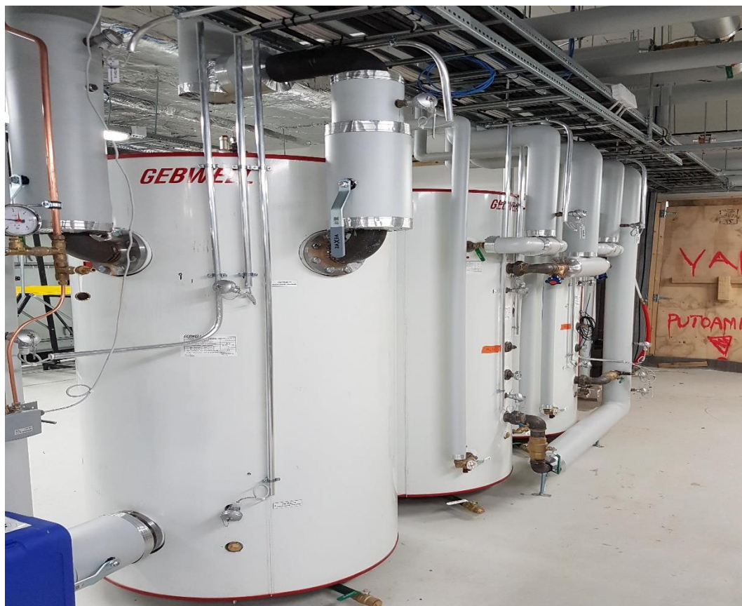
Kuva 6. Maalämpöjärjestelmän käyttövesi-, sekä kaksi energiavaraajaa.
