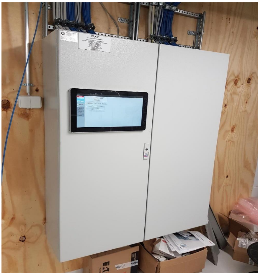
Kuva 16. VAK1 asennettuna lämmönjakuhuoneen seinälle.
