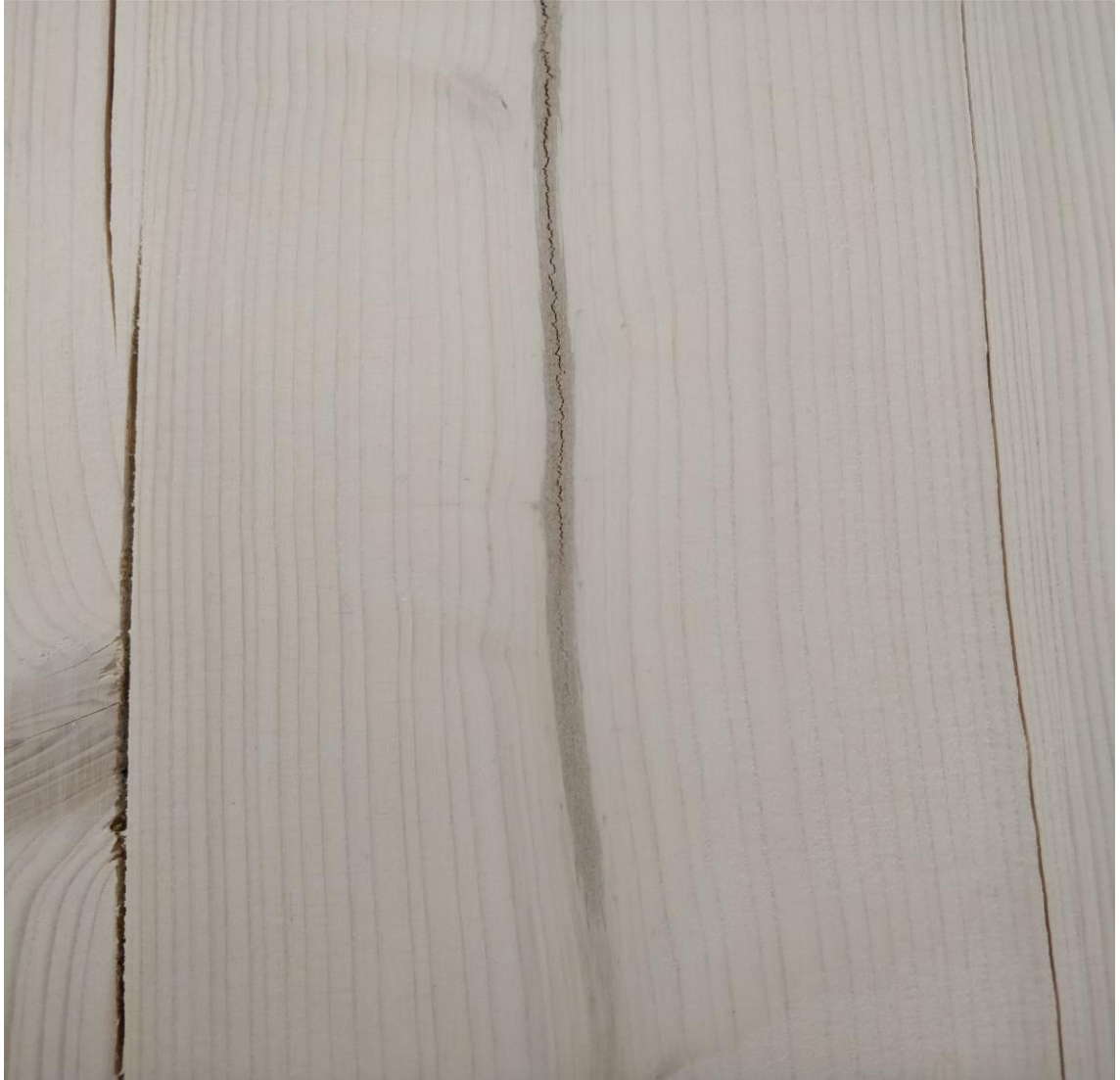
Kuva 25. Lähikuva lohkon 2 CLT:n halkeilusta 22.03.2019.
