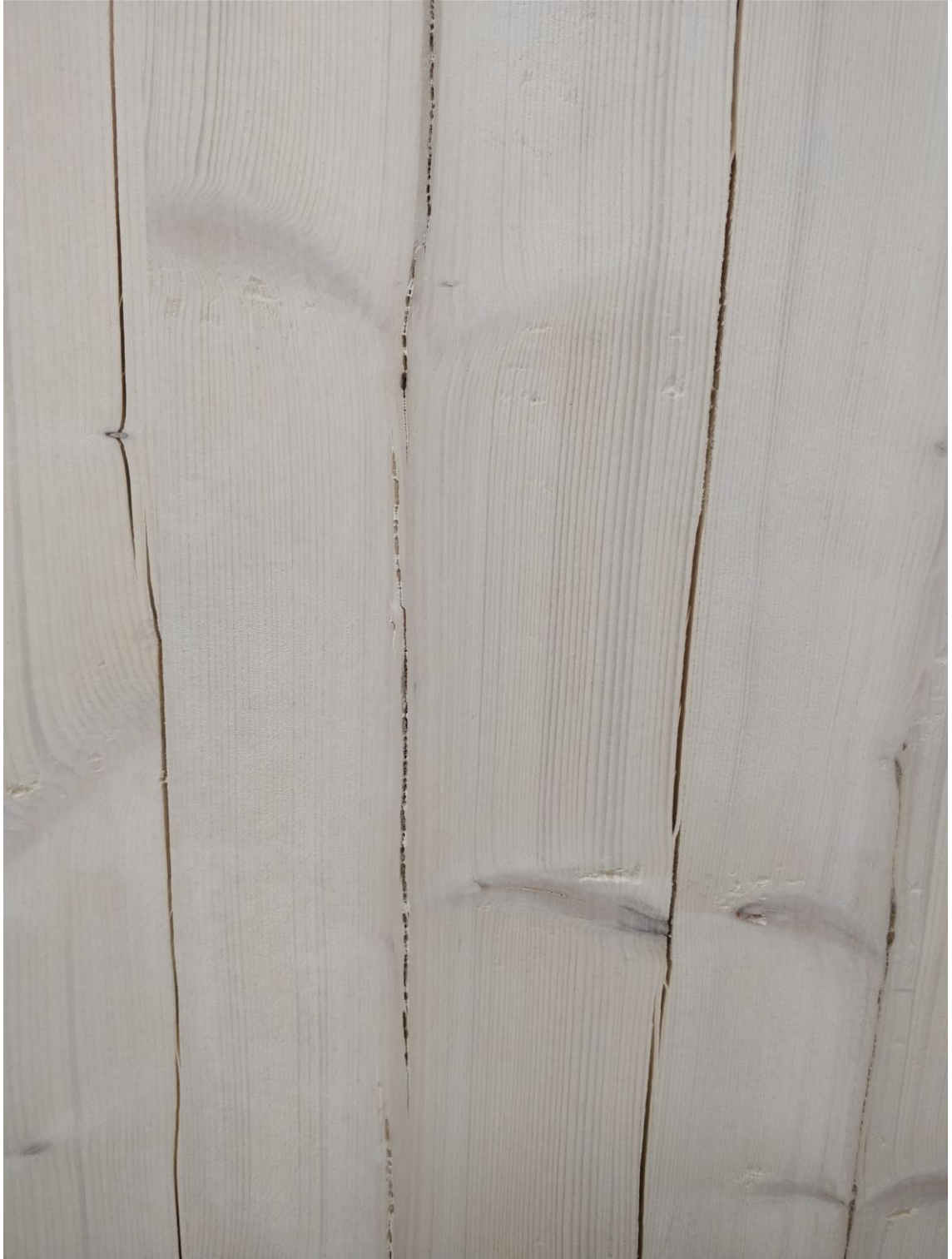
Kuva 24. Lähikuva 1. lohkon CLT:n halkeilusta 22.03.2019.
