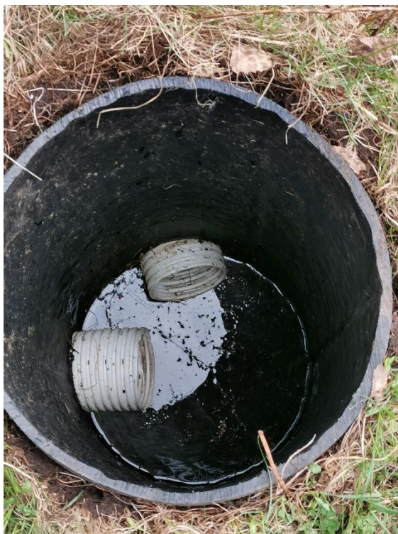
KUVA 5. Salaojan tarkastuskaivo (Niemi 2019-05-11)
