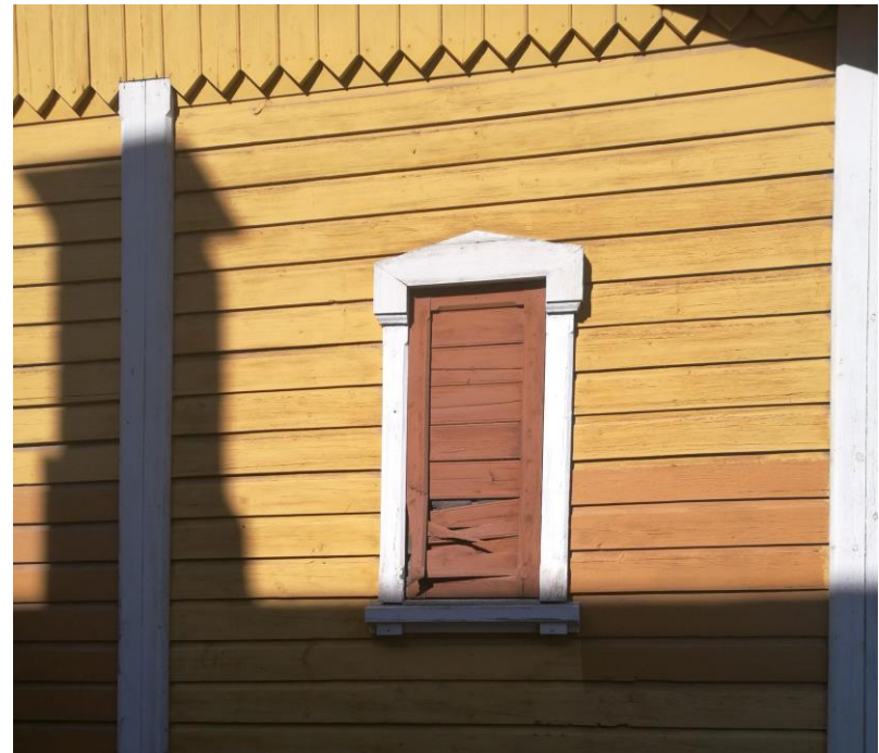
Kuva 31. Vajan rikkoutunut ikkuna-aihe
