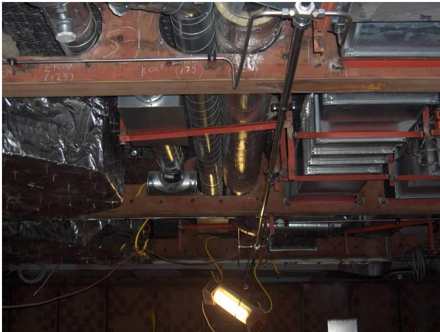
Kuva 9. Kattovuorauksen yläpuolella olevaa tekniikkaa (Elomatic 2019).
