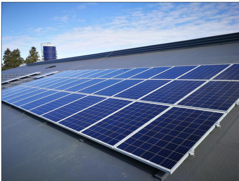
Kuva 20. Aurinkopaneelit PVC-katteessa Termater Oy:n ratkaisu. /1/.
