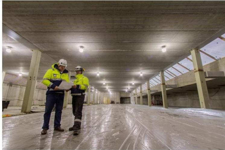
Työmaavalaistus toteutettuna noin 6 metrin rasterilla (kuva: El & Site (20) )
