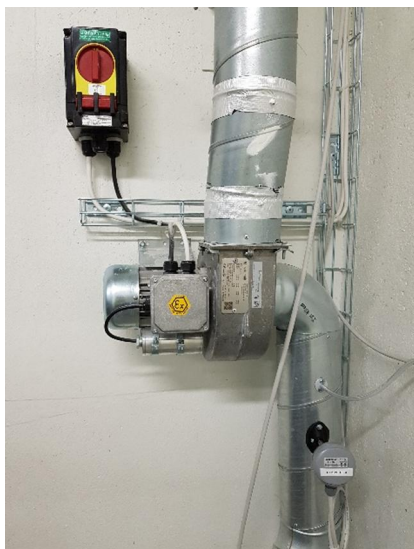
Kuva 9. Kaasupulloveraston ilmanvaihdon moottori ja turvakytin
