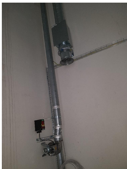
Kuva 7. Ilmanvaihtokanava liitettynä potentialintasaus järjestelmään
