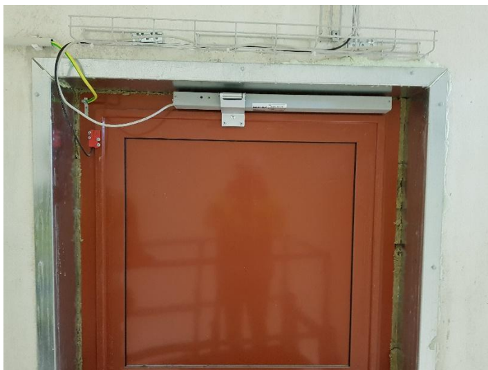
Kuva 8. ATEX-tilan savunpoistoluukun potentiaalintasaus
