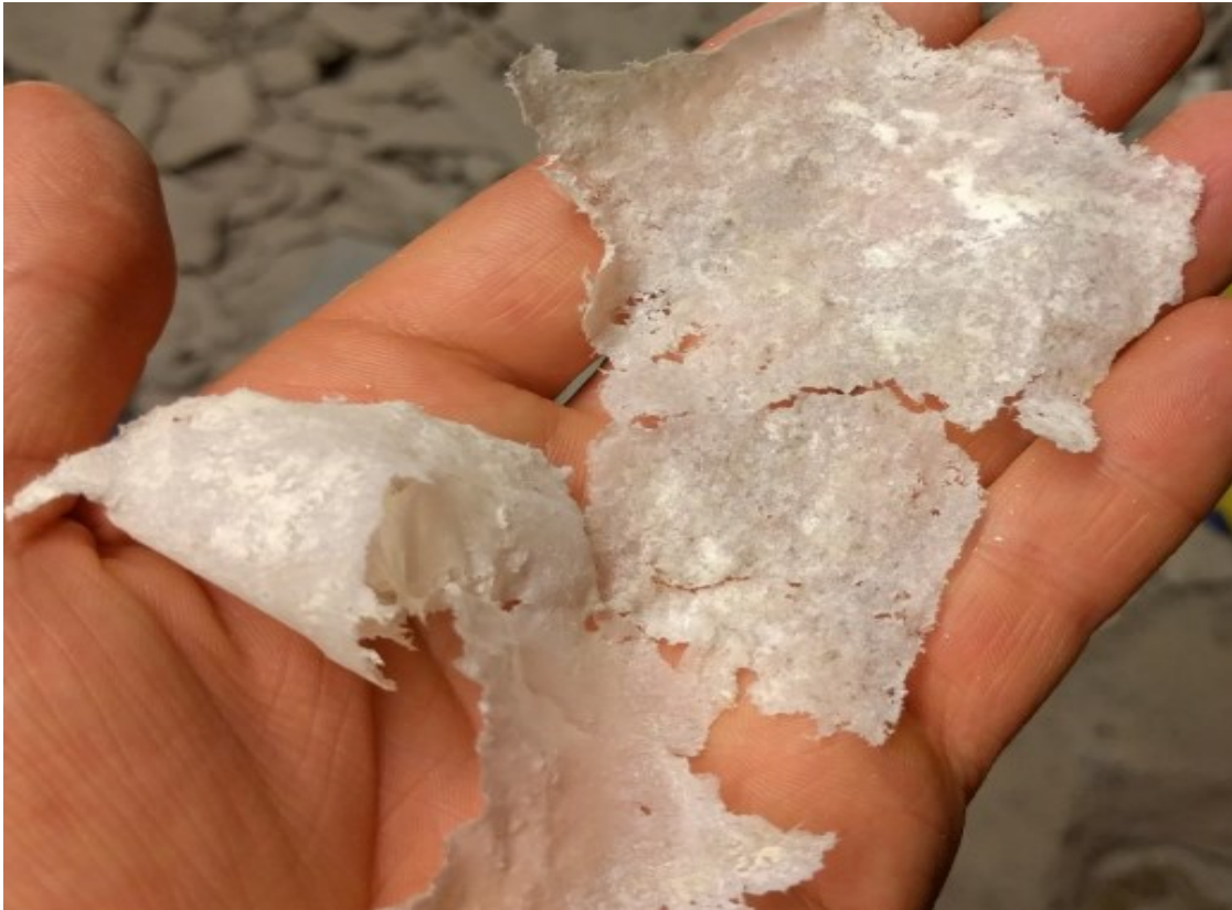
Kuva 5. Höyrynsulkumuovi näytti ja se myös tuntui hauraalta ja ohuelta.
