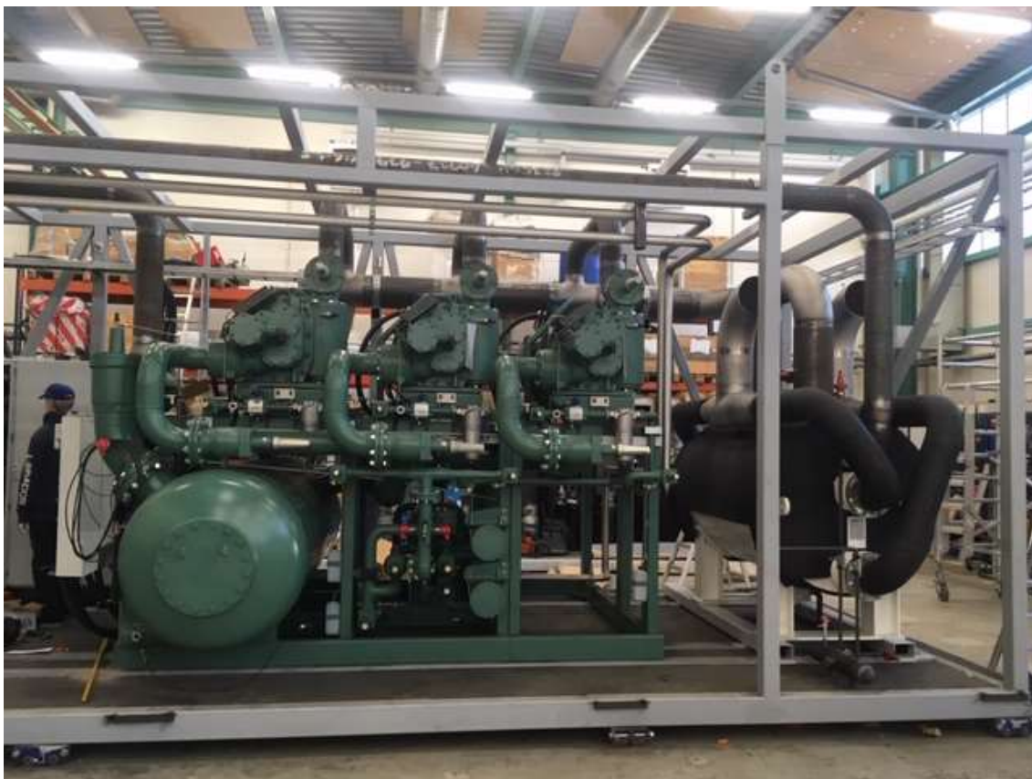
Kuva 25. Kompressoripaketti Findrin tehtaalla. Kuvassa näkyy kolme ruuvikompressoria paketin päällä, alla vasemmalla yhdistetty öljynerotin/-säiliö ja alla keskellä öljynjäähdytin. Kompressoripaketin oikealla puolella höyrystin.
