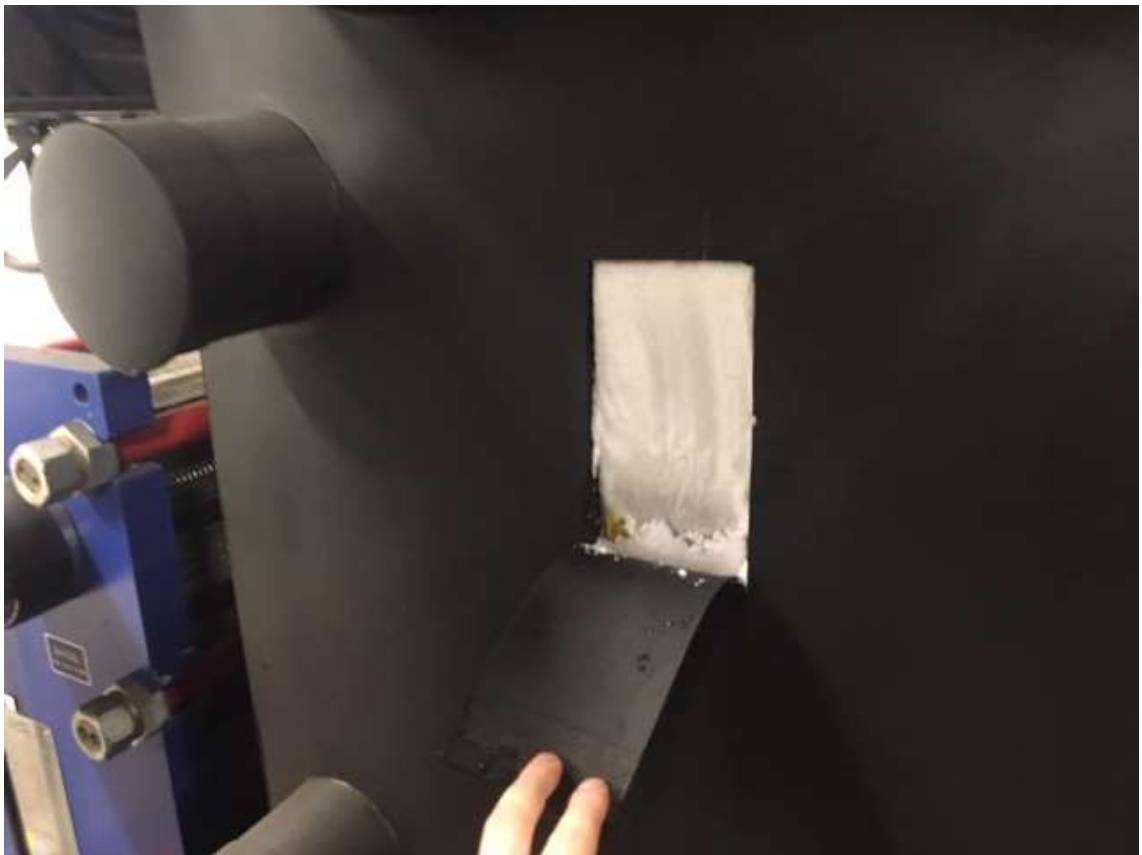
Kuva 14. Erään laitoksen höyrystimen kyljessä oleva tyyppikilpi laitoksen ollessa käynnissä.
