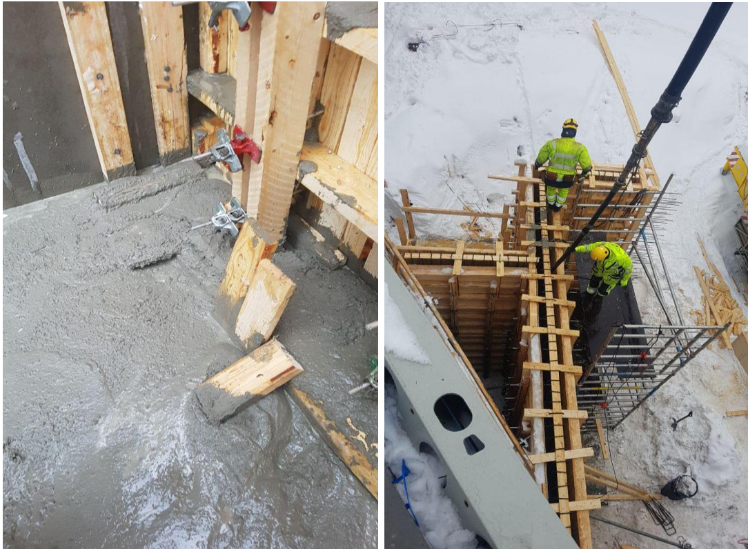
Kuva 33 Kuvan vasen puolella näky, miten betoni valui pois päin muotista. Oikean puolella valetaan betonia autolla, joka on varustettu puomilla.
