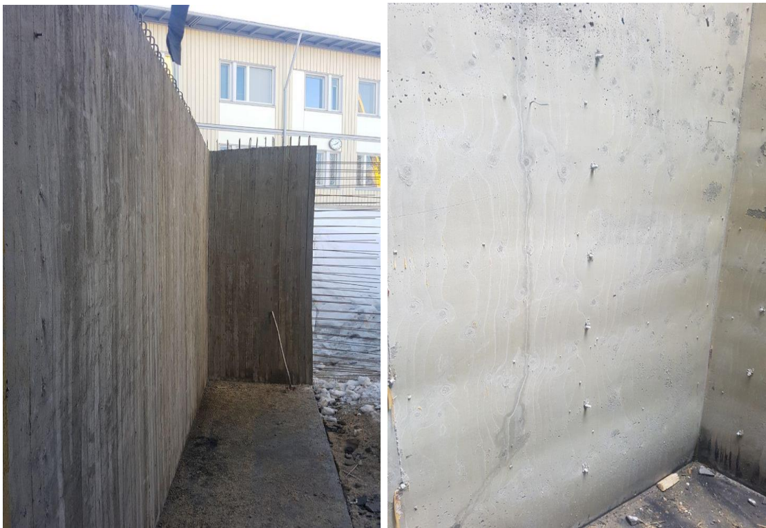
Kuva 34 Seinän näkyvä pinta muottipurun jälkeen. Kuva 35 Vaneri on huomattavasti taipunut.
