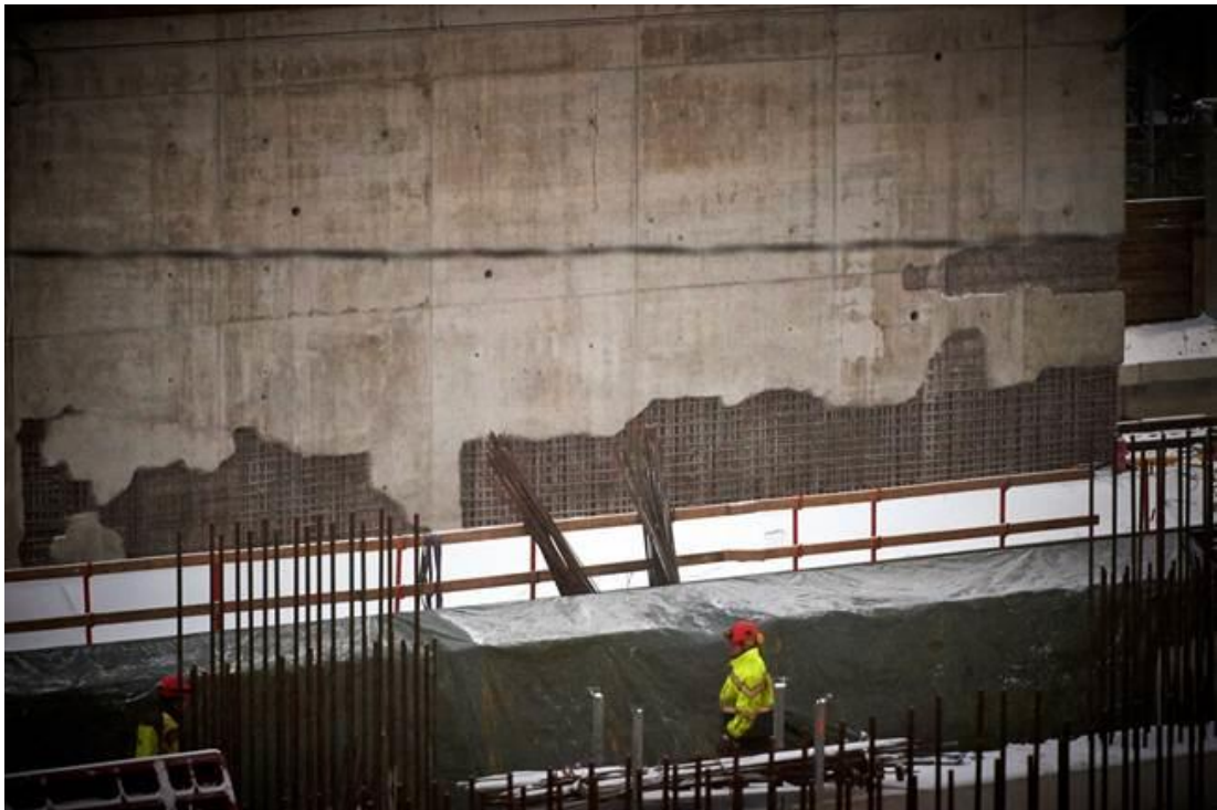
Kuva 32 Tyksin t3-sairaalan työmaalla epäonnistunut seinän valu, turun sanomat. [25]
