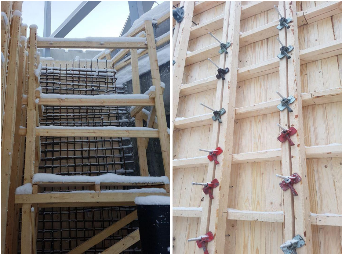
Kuva 29 Vasemmanpuoleisessa kuvassa nähdään, että muotin sisällä on lunta ja jäätä. Oikeanpuoleisessa kuvassa on esitetty muottilukon jako asennettuna alumiinitangoilla.
