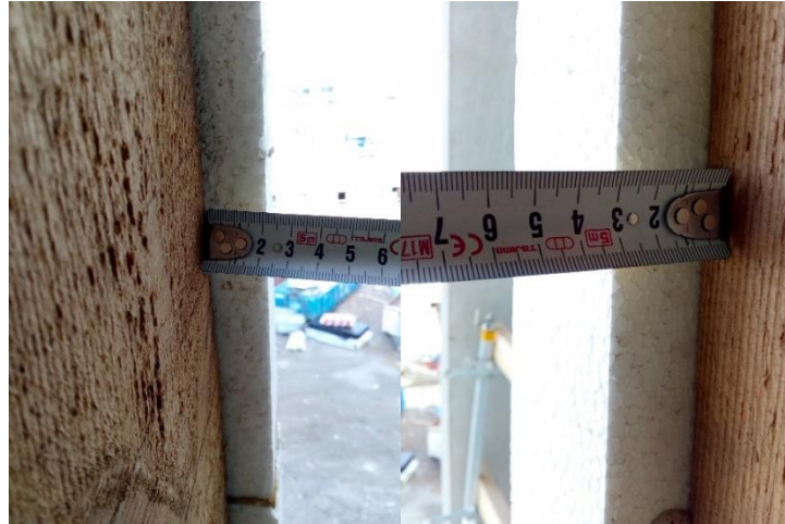
Kuva 34. Elementtitehtaalta tehty virhe kostautui työmaalla.
