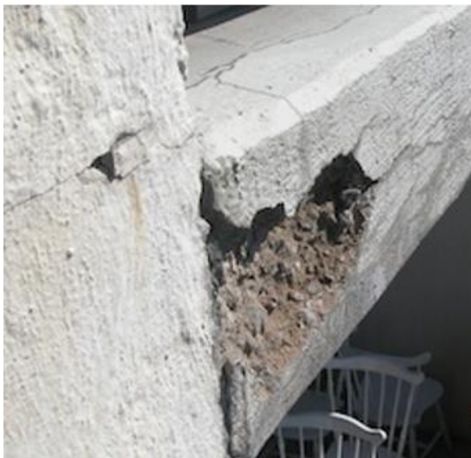
Kuva 5. Betonin rapautumisesta johtuva betonirakenteen vaurio. [2]
