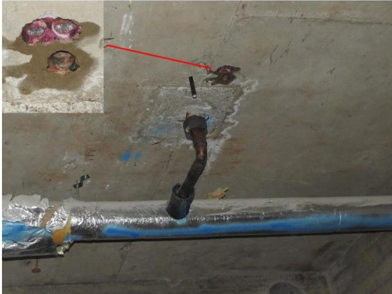
Kuva 18. Kattokaivon kohdalla pienelle alueelle levinnyt kosteuden aiheuttama valkoinen jälki. Noin 5 cm päässä jäljestä ei enää karbonatisoitunutta betonia havaittu [8]
