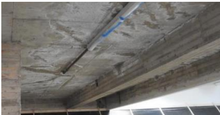
Kuva 14. Kosteuden aiheuttama jälki ylemmän tason yläpohjalaatassa.
