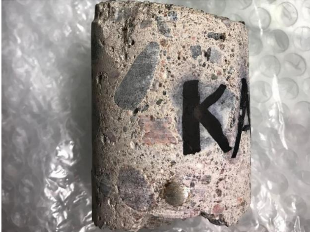
Kuva 17. Rakenneavauksesta otettu poranäyte. Poranäyte kokonaan karbonatisoitunut. Raudoituksen ympärillä havaittavissa ruostetta. [8]
