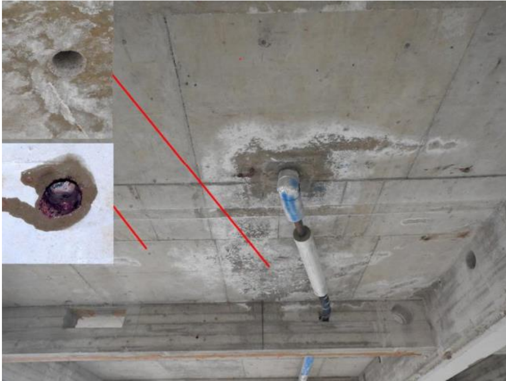
Kuva 20. Laajalle alueelle levinnyt kosteusjälki. Karbonatisoitunutta betonia esiintyi vielä 50 cm päässä kosteusjäljistä. [8]
