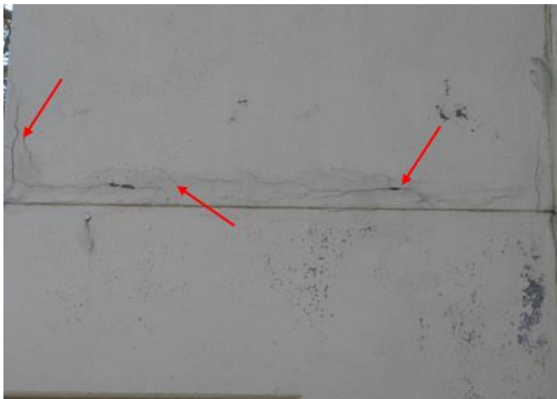
Kuva 1. Korroosion seurauksena lohkeillutta betonia. [2]
