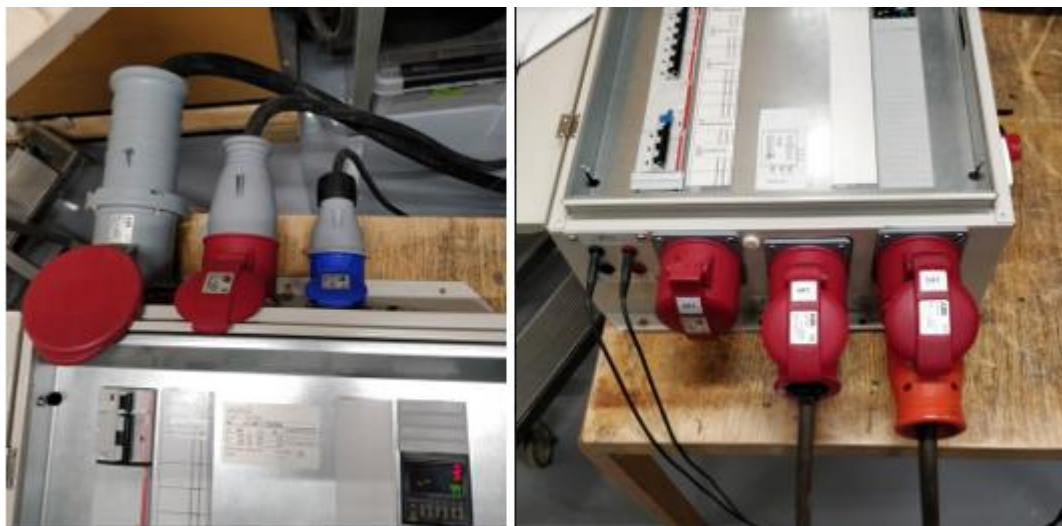
Kuva 22. Syklisen vanhennuskeskuksen tuloliitännät vasemmalla ja lähtöjen liitännät oikealla
