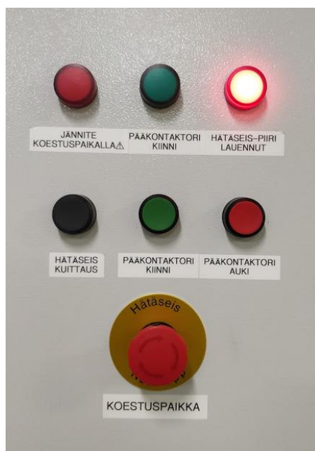
Kuva 19. Koestuspääkeskuksen ohjauskytkimet, indikoinnit ja turvarele.
