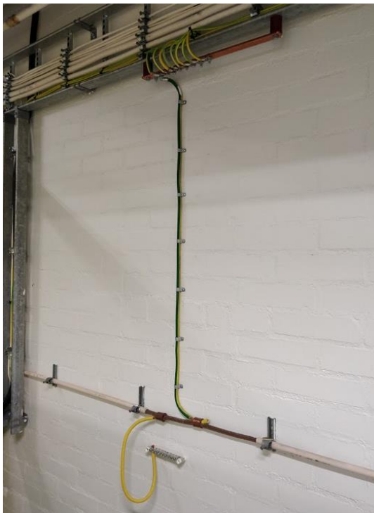
Kuva 26. Potentiaalintasauskisko ja maadoitusjohtimet.
