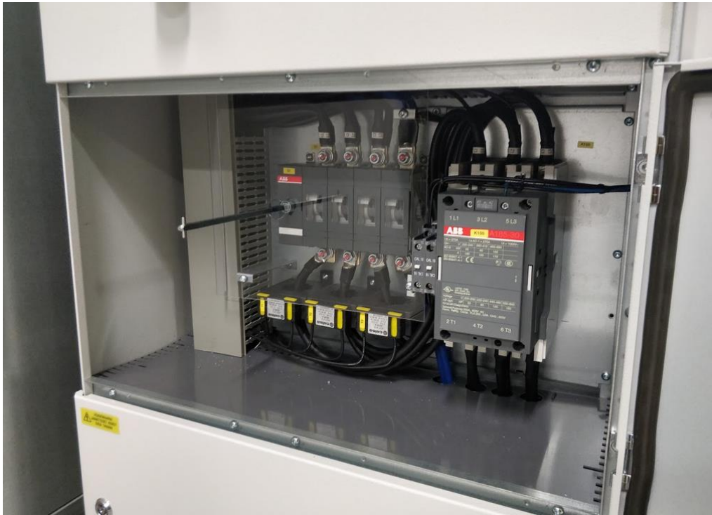
Kuva 17. Koestuspääkeskuksen pääkytkin, virtamuuntajat ja pääkontaktori.
