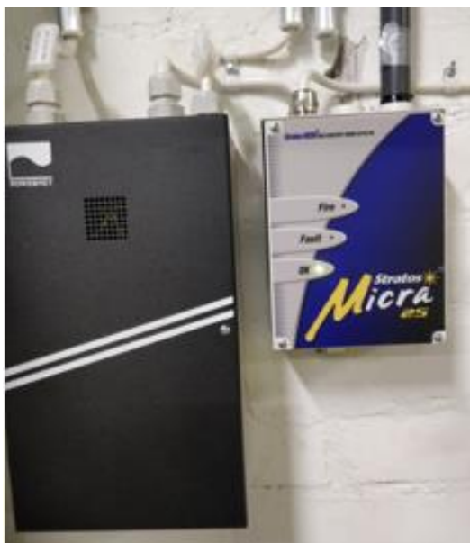
Kuva 14. Näytteenottojärjestelmän ohjaus- sekä akkukotelo ja näytteenottoputki.
