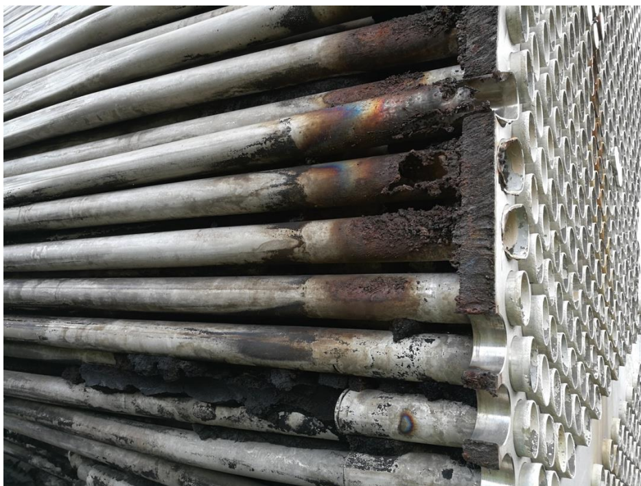
KUVA 9. Esihaiduttimen alkuperäinen putkipaketti. (Powerflute Oy 2018)
