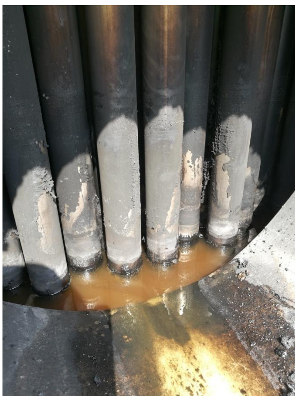
KUVA 10. Käytössä oleva putkipaketti miesluukusta katsottuna. (Powerflute Oy 2018)
