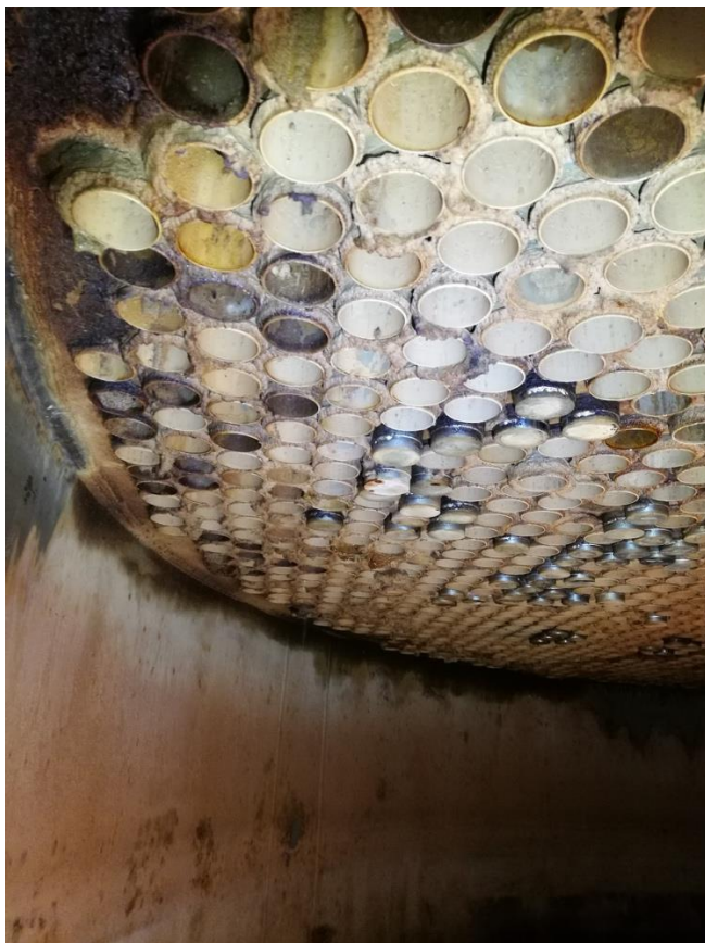
KUVA 11. Käytössä oleva putkipaketti alapuolelta katsottuna (Powerflute Oyj 2018)
