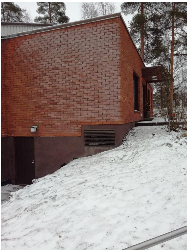
Kuva 25. Tuloilmasäleikkö rakennuksen ulkoseinässä (Tissari 2018-11-30)
