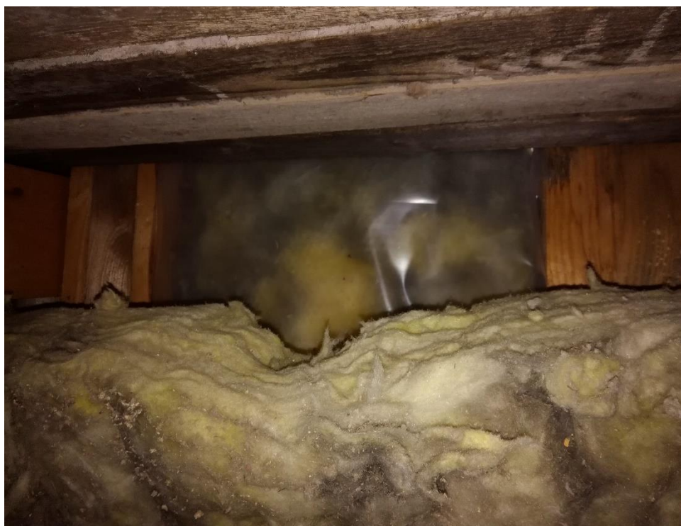
Kuva 14. Yläpohjan tummunutta lämmöneristettä ja tummunut aluslaudoitus (Tisari 2018-11-01)
