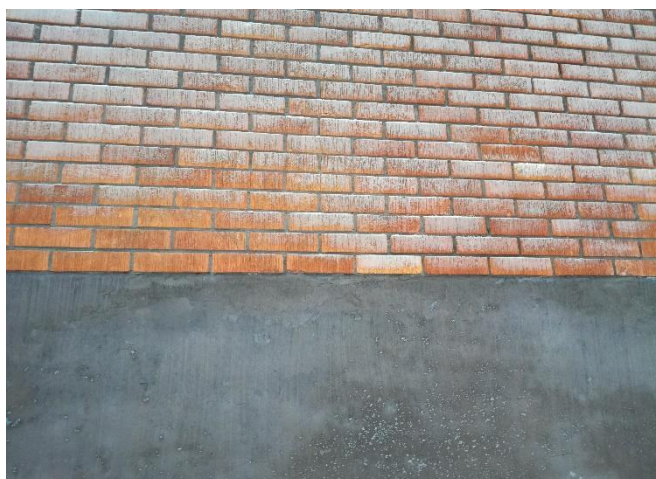
Kuva 17. Tiilimuurauksen tuuletusraot puuttuvat (Tissari 2018-11-30)
