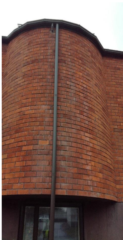
Kuva 15. Kosteuden aiheuttamia jälkiä (Tissari 2018-11-01)
