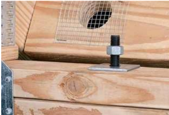
Kuva 24. Painuman aiheuttama rako puun ja ankkurimutterin välissä (Simpson Strong-Tie Company Inc. 2018, 13).
