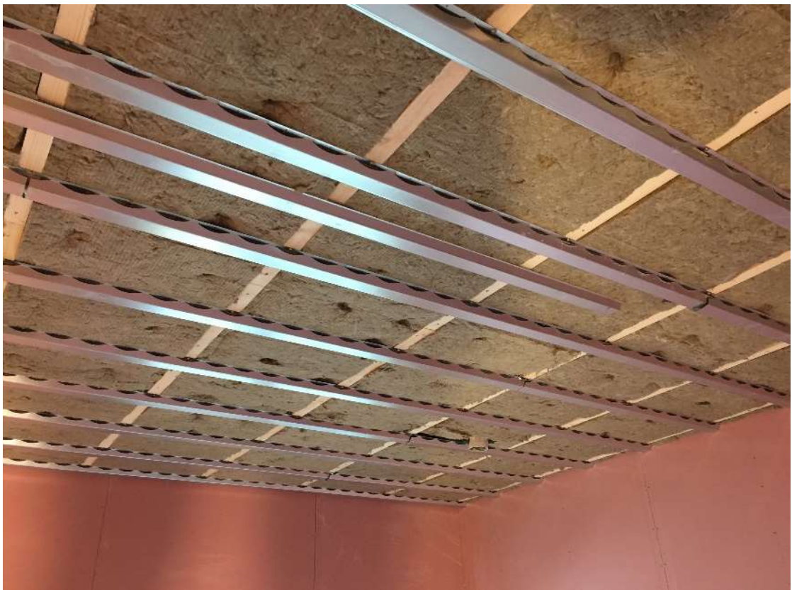
Kuva 68. Jousirangat huoneiston katossa.
