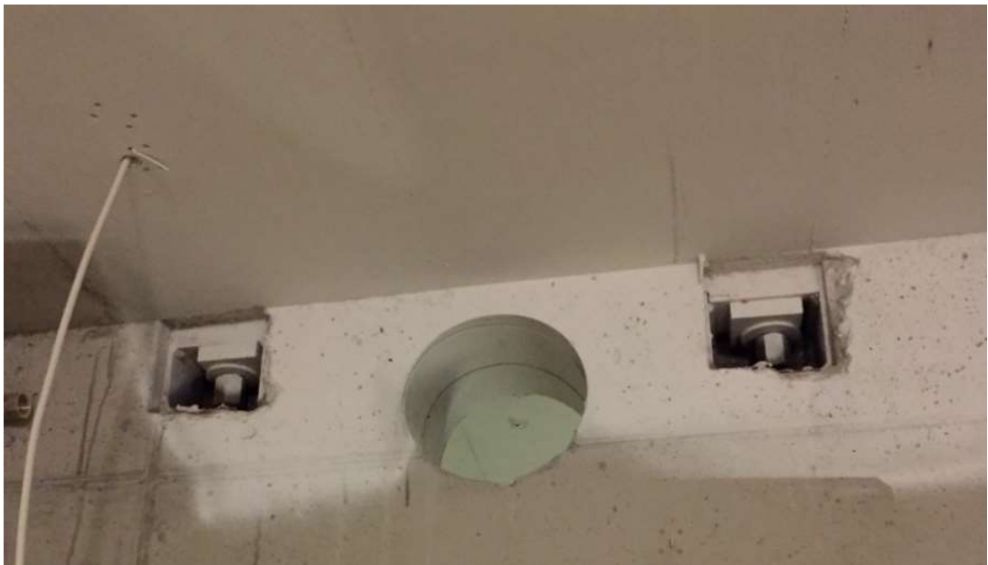
Kuva 48. Seinäkengät betoniholvin alapinnassa väliseinässä.
