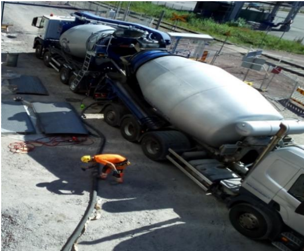
Kuva 1. Tukkeutunut letkulinja IT-betonin erottumisen seurauksena.
