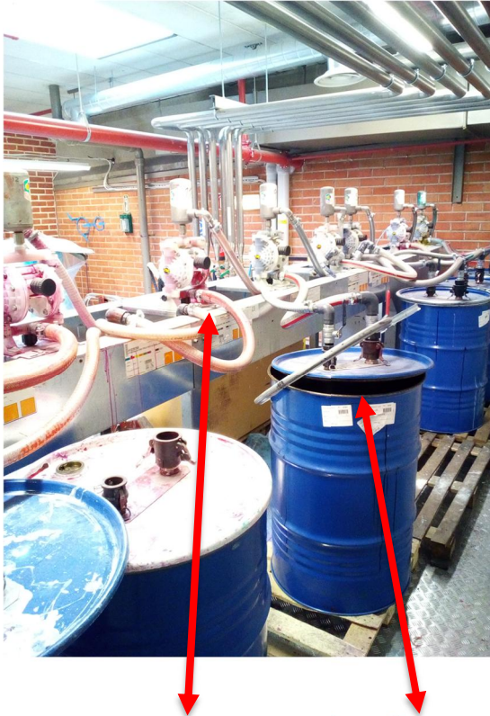
Kuva 4. . Pumppausasemat ja pastatynnyreitä
