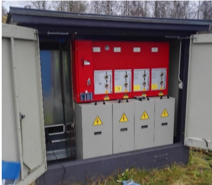
Kuva 7. puistomuuntamoon sijoitettu erotin
