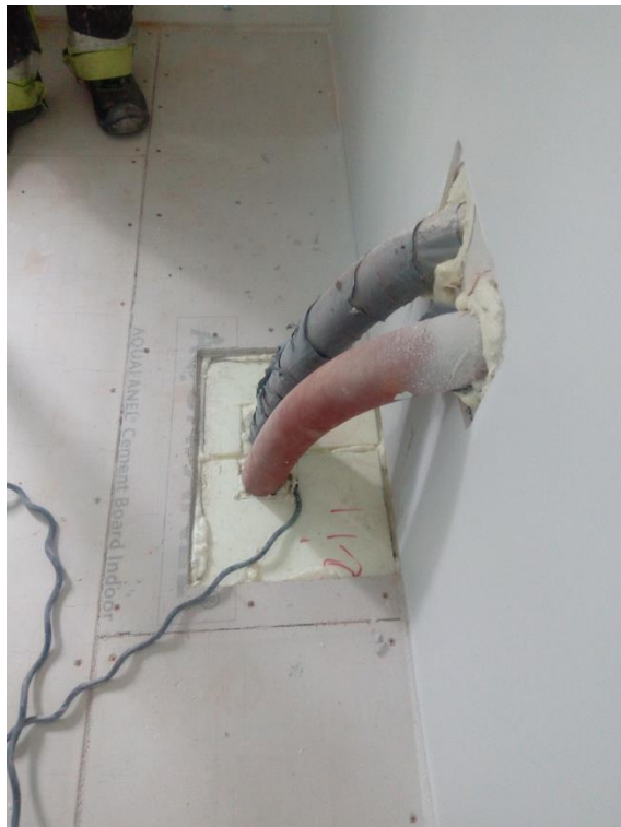
Kuva 3. Väliaikaisesti tiivistetty läpivienti.
