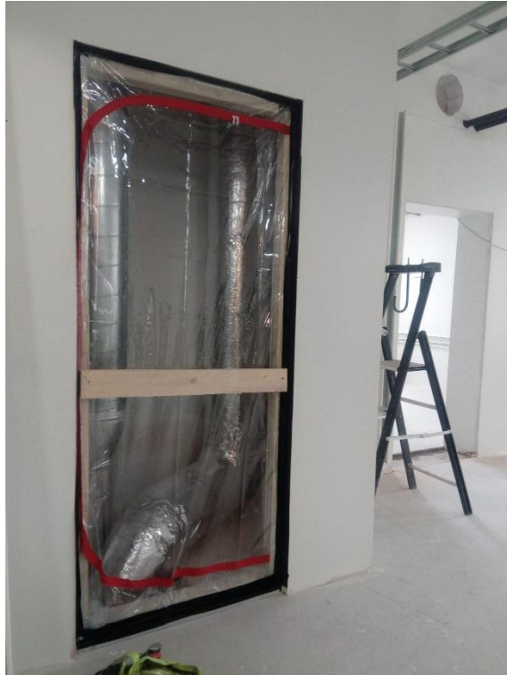
Kuva 6. Suojattu hormi kerroksessa.
