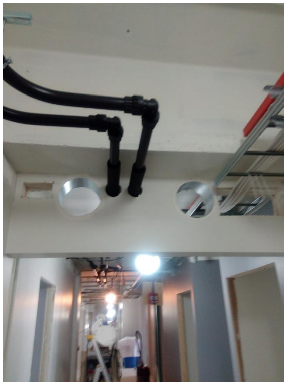
Kuva 4. Holkkaputkilla kapseloituja läpivientejä.
