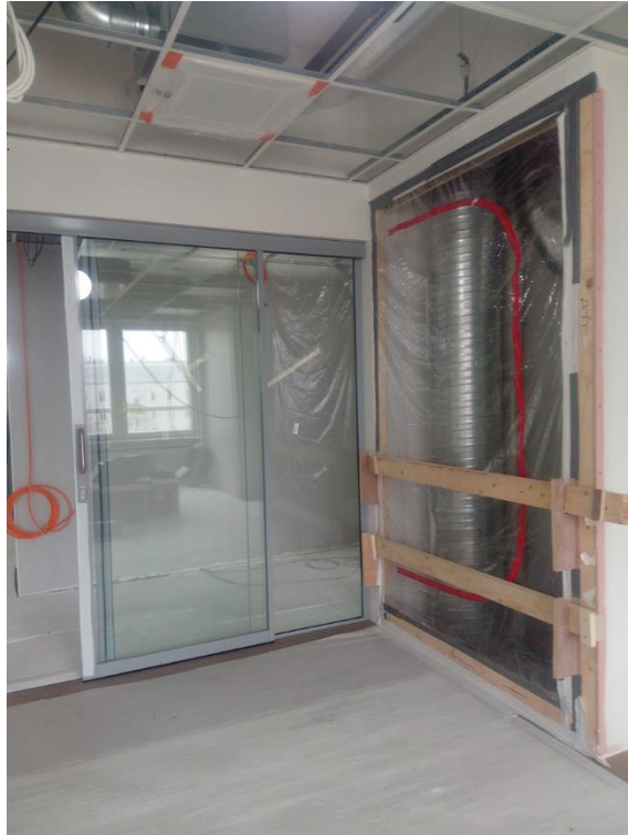
Kuva 11. Suojattu IV-päätelaite katossa ja IV-kanava hormissa.
