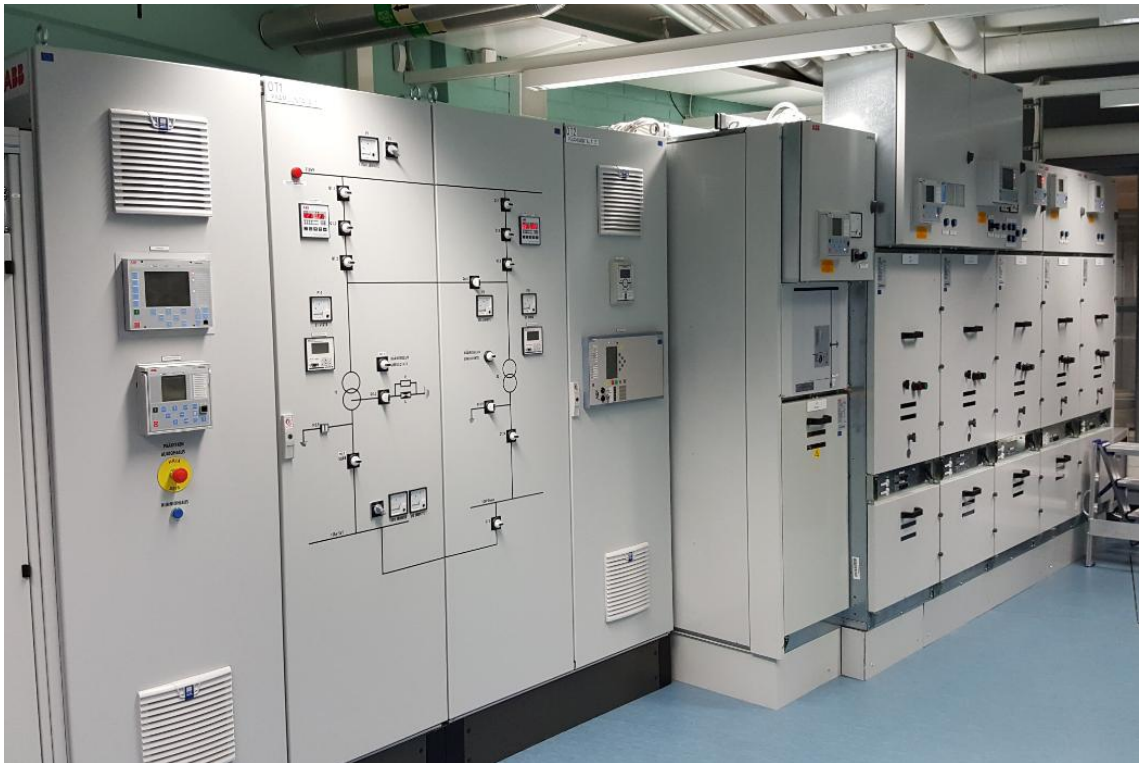
Kuva 1. 110 kV Demolaitteisto ja 10 kV keskijännitekojeisto
