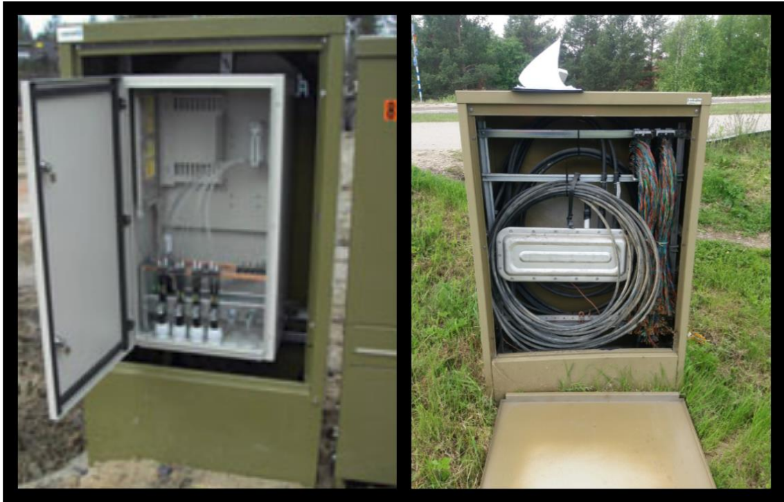
Kuvio 31. Vasemman puoleiseen jakokaappiin on sijoitettu jatkoskaappi, kun oikean puoleisessa kaapissa valokaapelijatkos on viety jakokaappiin, jossa on myös kuparikaapeleita (Onninen 2011a)
