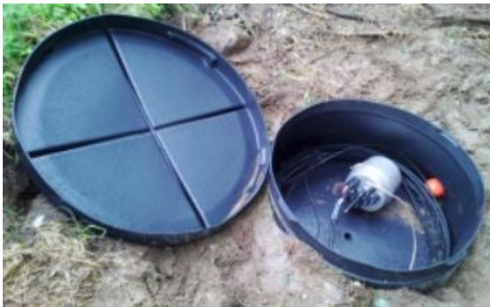
Kuvio 29. Valokaapelijatkos ja sondipallo muovikaivossa (Nestor Cables a)
