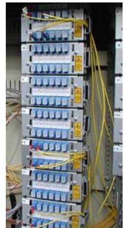
Kuvio 40. Kytkentöjä ristikytkentäkaapin sisällä olevissa liitinlevyissä (Onninen 2011b)
