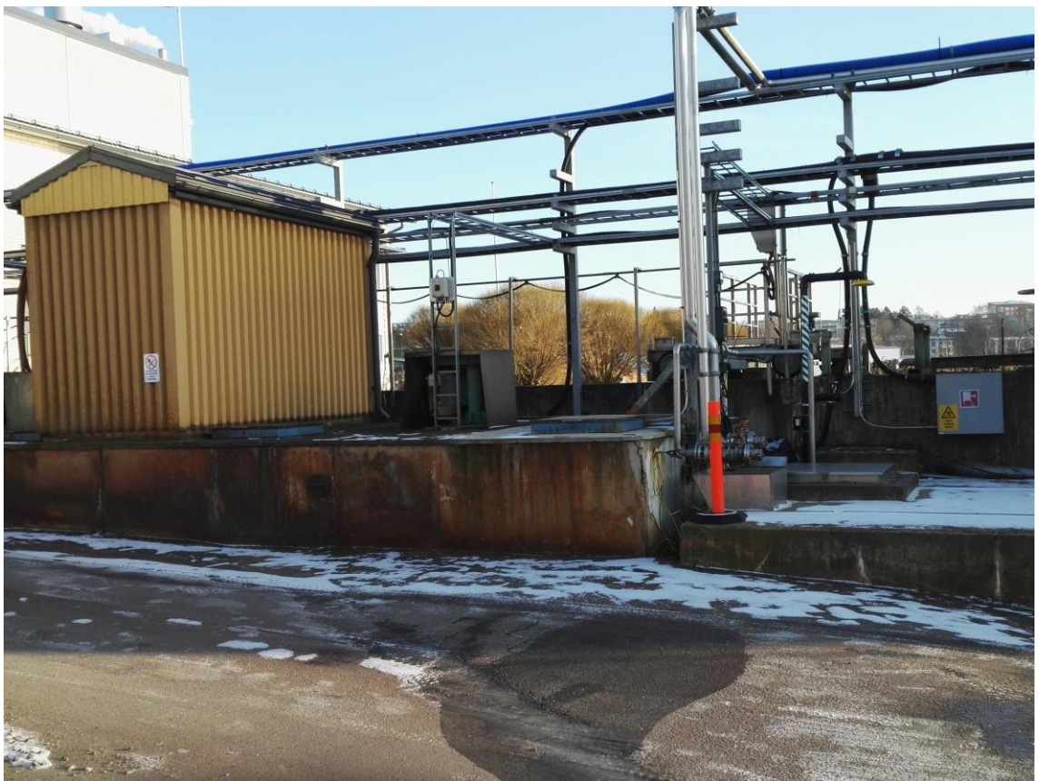
KUVA 6. Ferrisulfaattisäiliöiden täyttöpaikka. Säiliöt maan alla.
