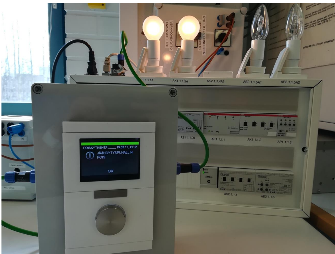
Kuva 48. Kolmas indikoitilamppu juuri sammunut ja viesti jäähdytyspuhaltimen poiskytkennästä ilmestynyt näytölle.
