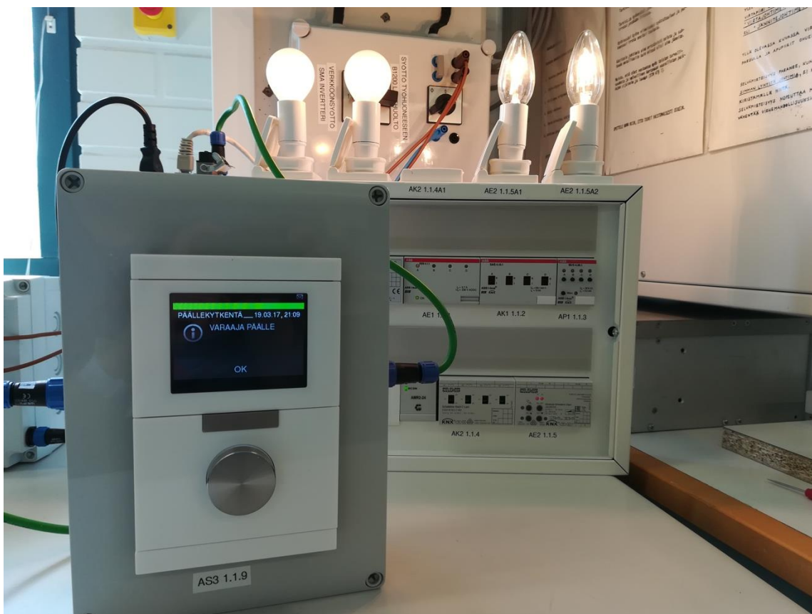
Kuva 47. Tehon tuotto ylittänyt 1800 W, neljäs indikoitilamppu juuri syttynyt ja viesti varaajan päällekytkennästä ilmestynyt näytölle
