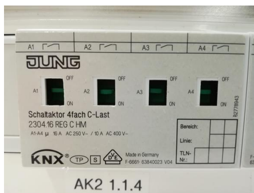
Kuva 42. Demokeskuksessa sijaitseva kytkintoimilaite, jonka yksilöllinen osoite on 1.1.4
