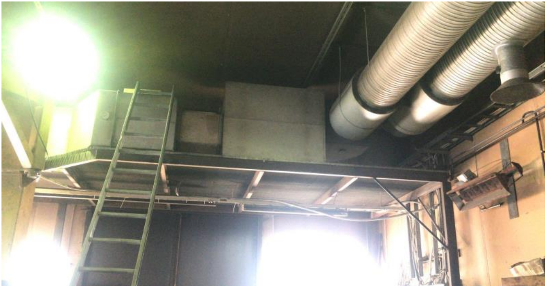
Kuva 3. Ilmanvaihtokone varastohallin katossa
