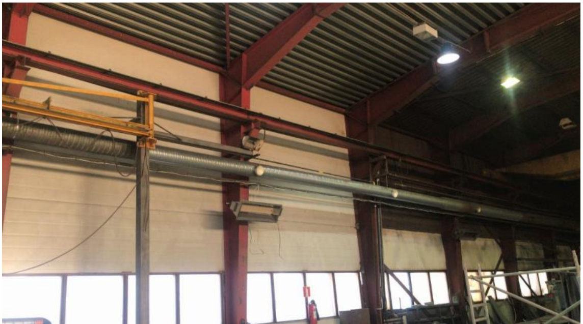
Kuva 7. Kuvassa hallin yksi useasta kaasusäteilylämmittimestä. Kuvassa on myös raitistuloilmaputki
