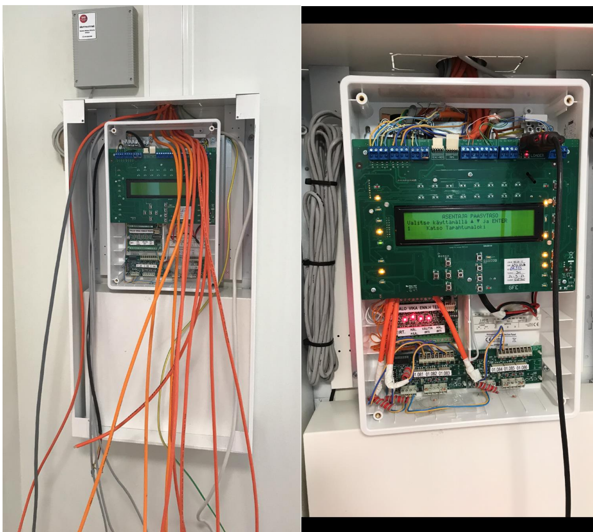
Figur 7: Centralen i Orivesi före och efter inkoppling.
