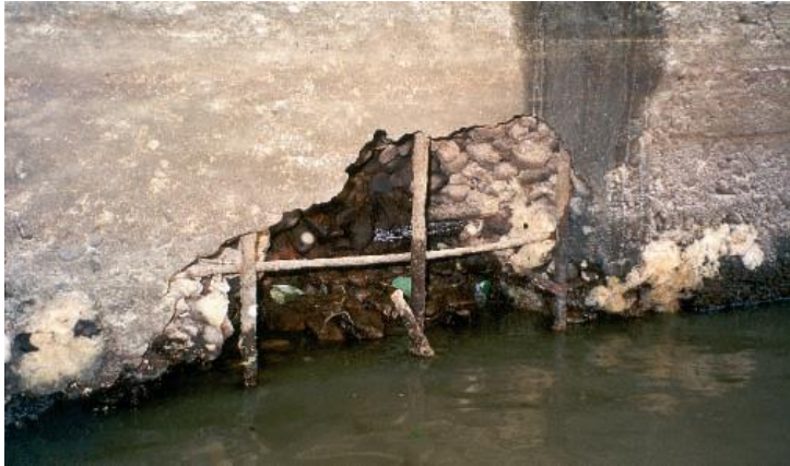
Kuva 11 Veden virtauksen aiheuttama eroosio betonirakenteessa (Silko 2007)
